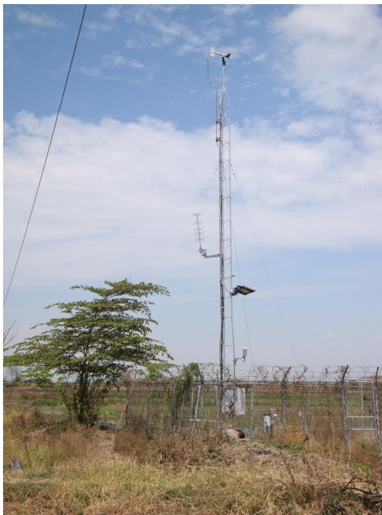
Figura 14. Fotografía de una estación meteorológica automática instalada en la provincia de Loja.
