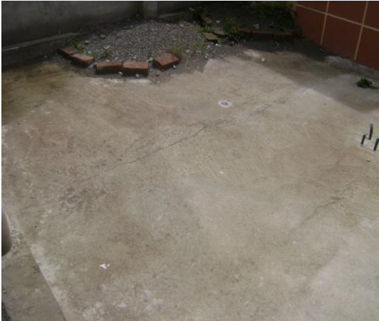
FOTO 23: Fisuras en pisos
