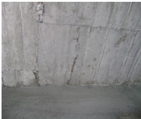
FOTO 22: Filtración de agua en losa
