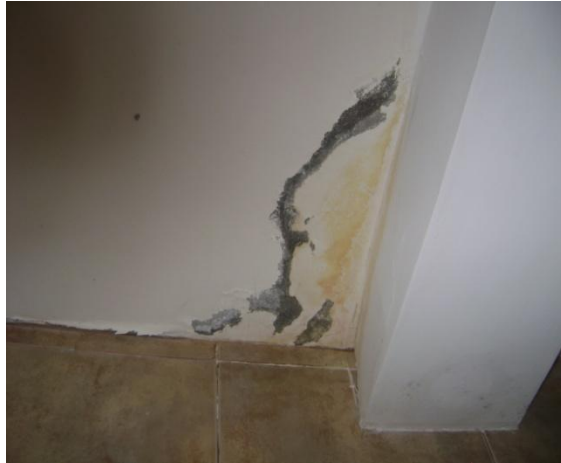
FOTO 24: Filtración de agua en losa
