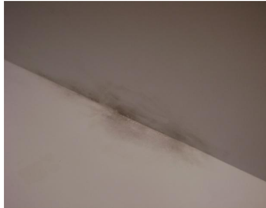
FOTO 26: Fallas en cielo raso por filtración agua
