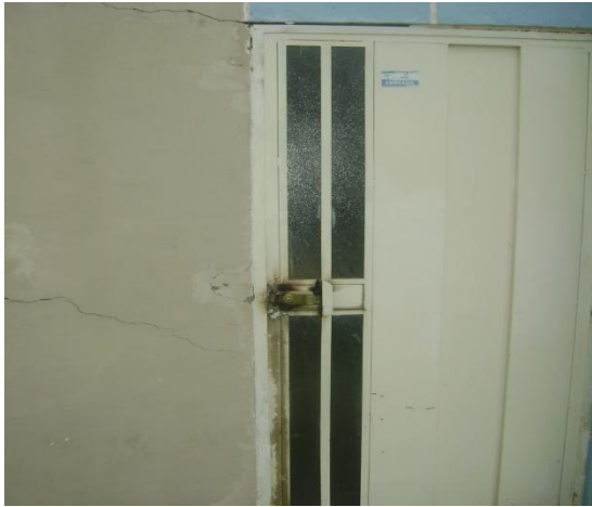
FOTO 17: Fallas en puerta exterior
