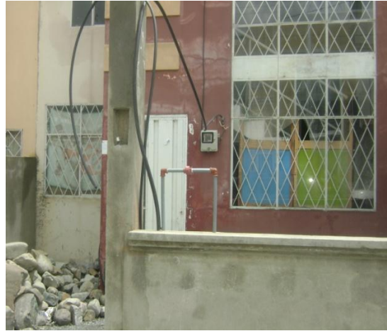
FOTO 18: Fallas en instalaciones agua y eléctricas
