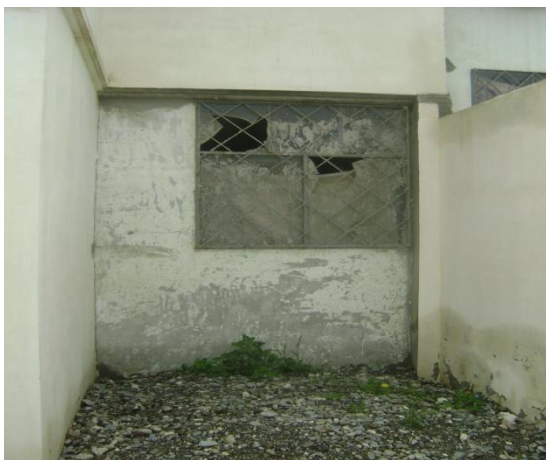
FOTO 21: Fallas en paredes por humedad
