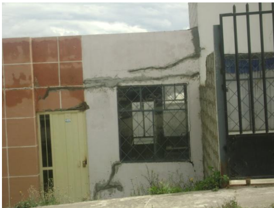
FOTO 9: Fallas en pared, puerta y ventana
