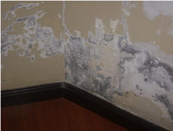
FOTO 25: Fallas en pared interior por humedad
