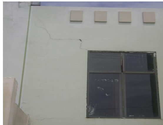
FOTO 10: Grietas en pared fachada
