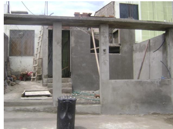
FOTO 8: Intervención ilegal y antitécnica
