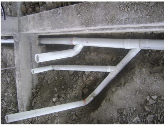
FOTO 15: Tubería PVC Aguas Servidas
