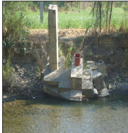
Fig. 17. Estación hidrométrica El Arenal destruida por socavación.
