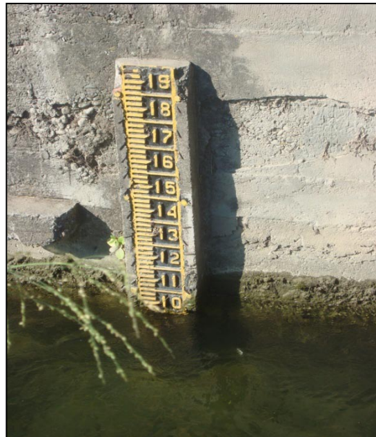
Fig. 21. Limnómetro de la estación hidrométrica El Arenal.
