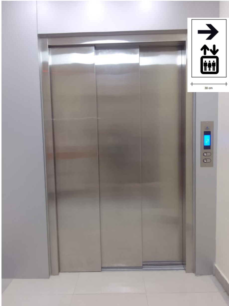
Indicativo de ubicación de ascensor
