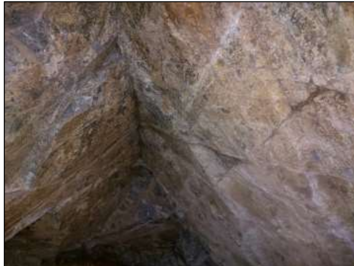
Figura 40: Desprendimiento de roca tipo cuña
