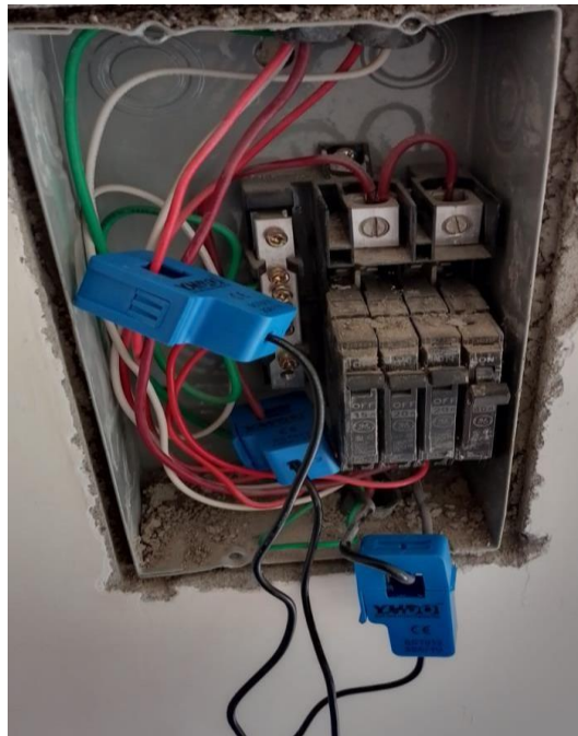
Figura 10: Instalación física de los sensores de corriente.
