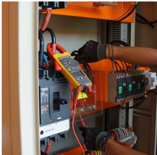
Figura 15. Medición de corriente y voltaje a un tablero de distribución Fuente. ( Tableros Eléctricos - STANDPARKER, s. f. )
