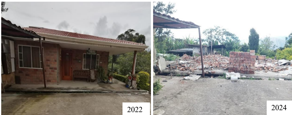
Figura 59. Daños en viviendas; Coordenadas UTM/WGS84/17S “X:694811.72; Y: 9535944.58”.
