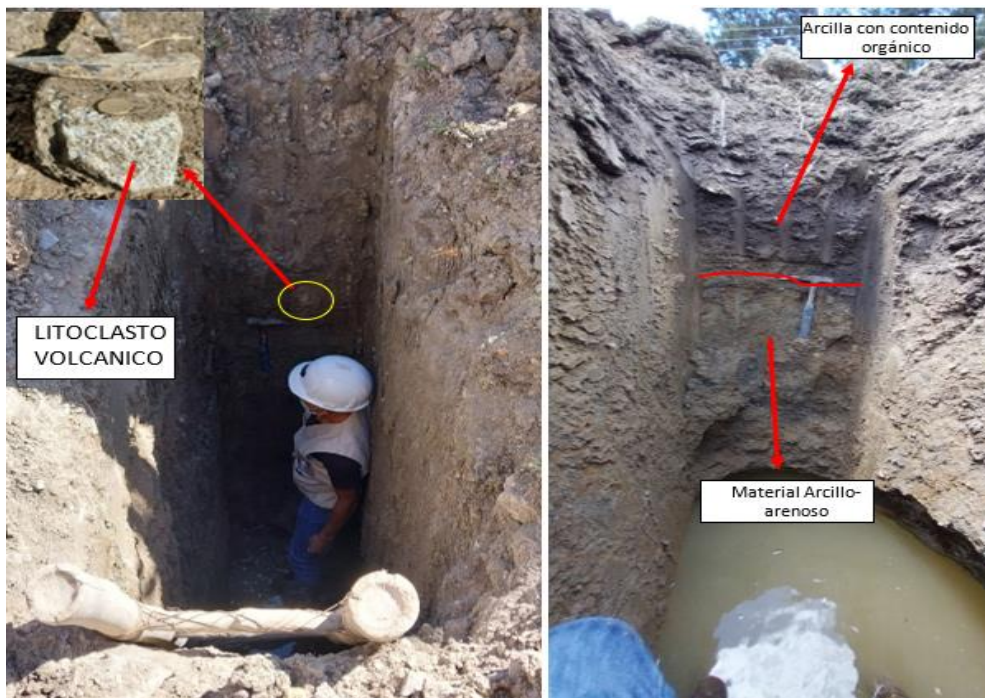
Figura 63. A la izquierda-Presencia de litoclastos volcánicos en la calicata 1; A la derecha litología de la calicata 7-se observa nivel freático a 2m de profundidad.
