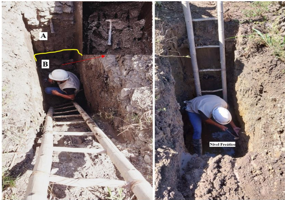
Figura 64. A la izquierda-Presencia de material arcillo arenoso con intercalaciones de sulfato de calcio alterado en la calicata 4; A la derecha litología de la calicata 2-se observa nivel freático a 2m de profundidad.
