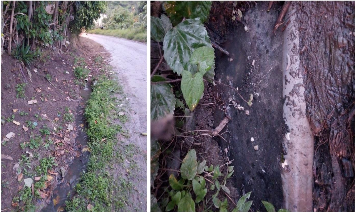
Figura 58. A la Izquierda (aguas provenientes de la irrigación y fosas sépticas); A la derecha (fosa séptica colapsada)
