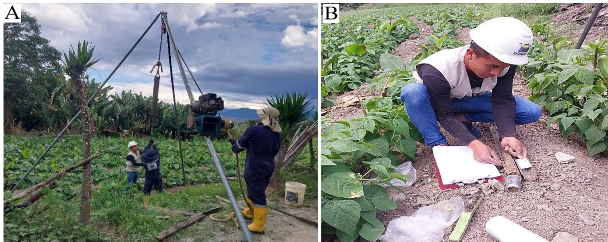
Figura 38. A) Ubicación del Equipo SPT; B) Etiquetado y toma de muestras Nota. Elaborado por el autor, 2024
