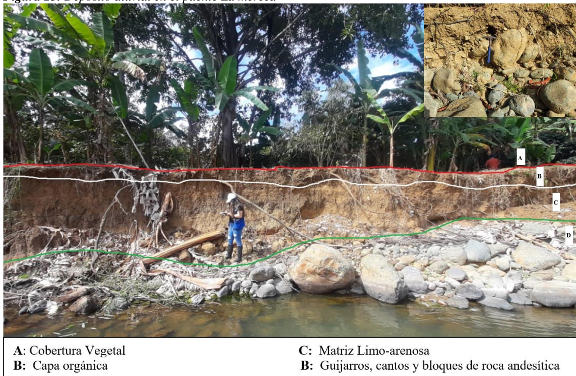
Figura 25. Depósito aluvial en el puente La merced
