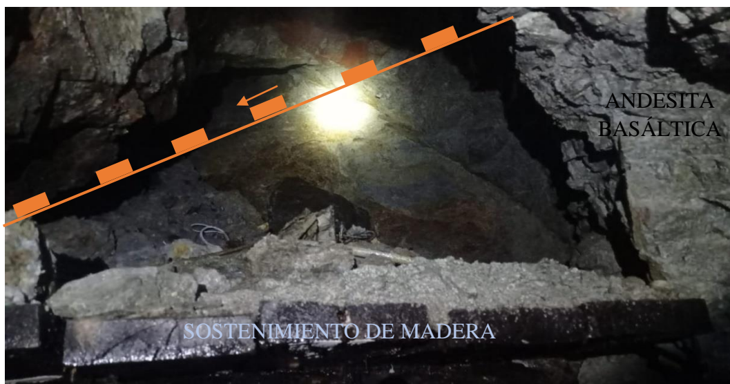
Fotografía 11. Falla normal de 2.5 m de salto de falla en el punto P54 a P57, con sostenimiento de madera.
