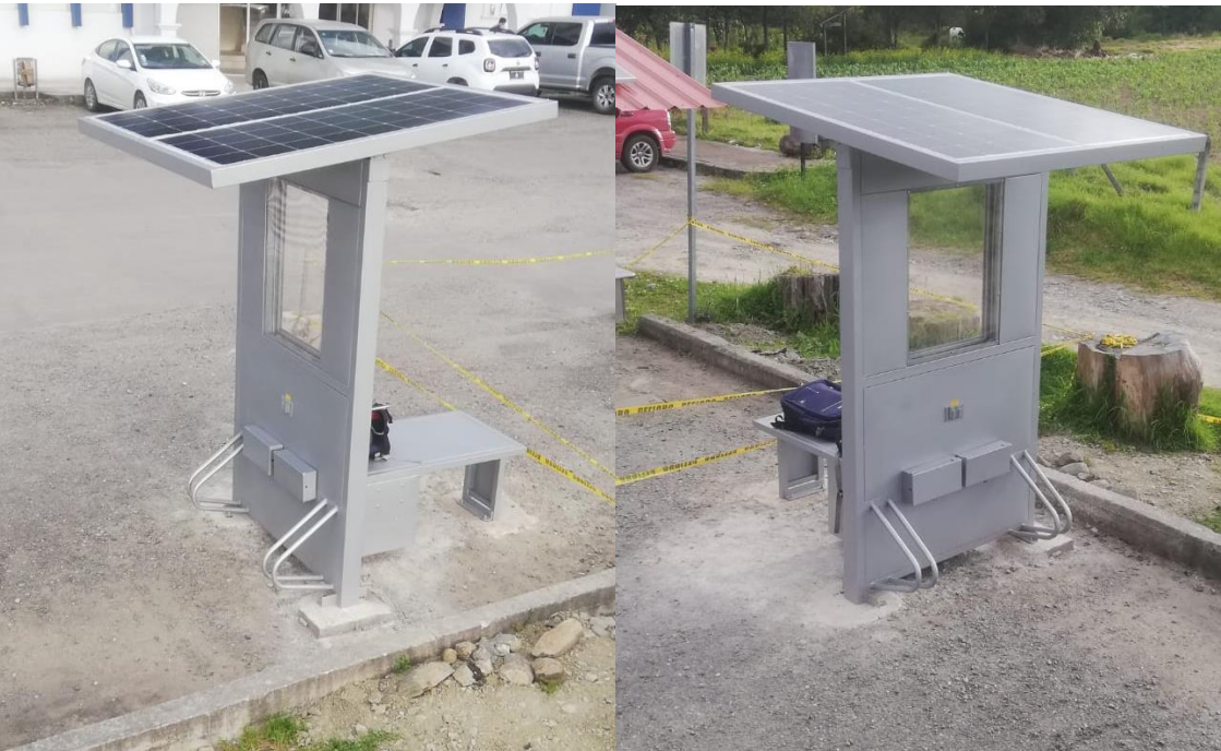
a) Estación solar terminada en funcionamiento en el día.
