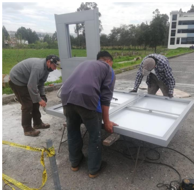
b) Instalación eléctrica de paneles solares
