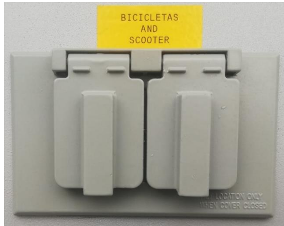
Figura 1. Tomacorriente de carga para vehículos eléctricos de baja potencia.
