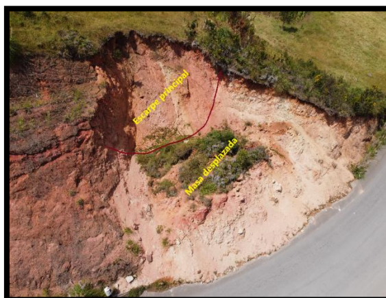
Figura 77. Deslizamiento 3. x: 743923,99; y: 9658376,54; z: 2739,35
