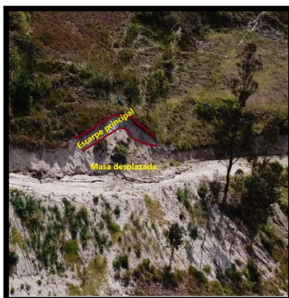
Figura 88. Deslizamiento 14. x: 744002,231; y: 9665759,501; z: 2381,8
