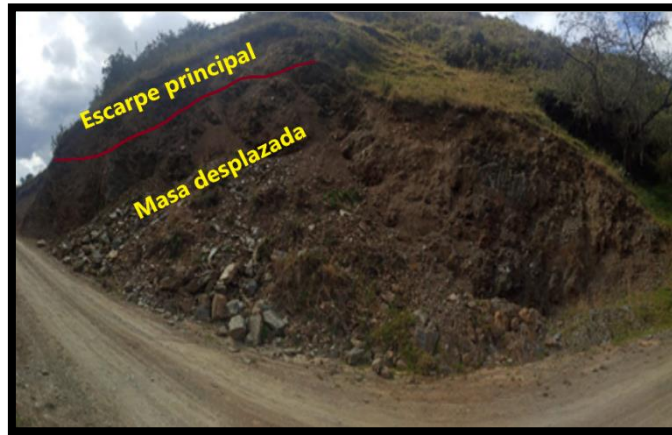
Figura 82. Deslizamiento 8. x: 747007,238; y: 9662471,682; z: 2768
