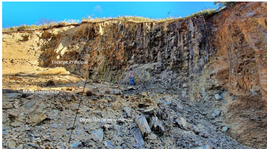
Figura 53: Deslizamiento rotacional (PDD-009), sector vía a Tarapo.
