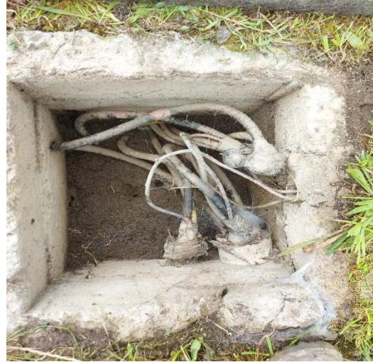
Figura A. 34: Pozo de revisión ubicado frente al bloque A5 Fuente: Compilada por el autor
