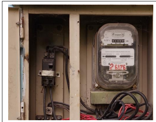
Figura 43. Proteccion Magneto-Termica del medidor de distribucion Nro. 26176
