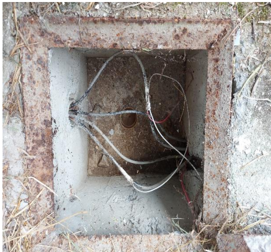
Figura A. 35: Pozo de revisión ubicado detrás del bloque A7. Ingreso de red eléctrica al bloque. Fuente: Compilada por el autor
