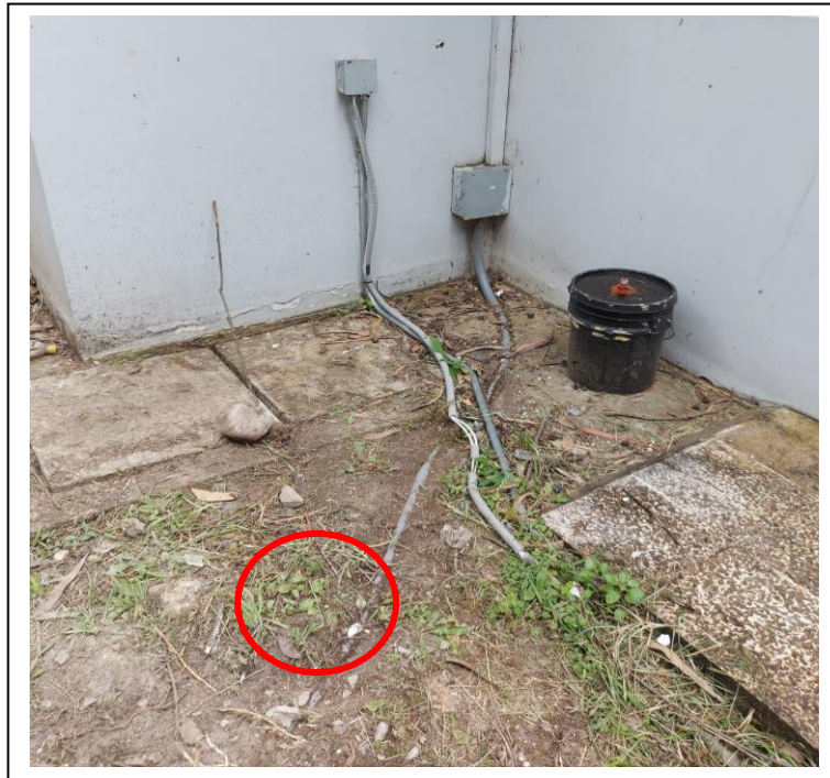
Figura 33. Pozo de revisión sin identificar detrás del bloque A4
