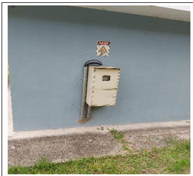
Figura 14. Medidor de distribución eléctrica ubicado en el Bloque A6 de la FEIRNNR.
