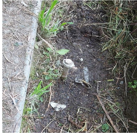
Figura A. 20: Puesta a tierra ubicada detrás del bloque A7. INACTIVA.
