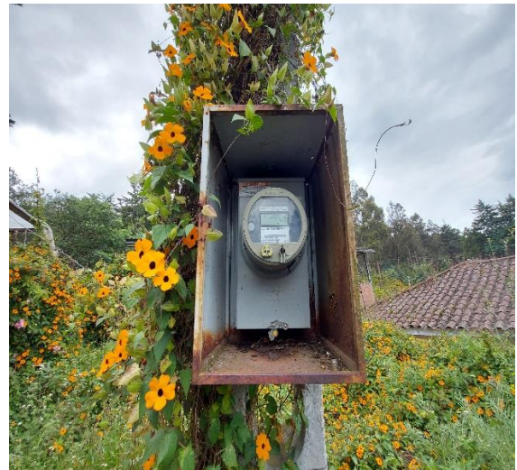
Figura A. 6: Medidor de distribución eléctrica 32529. Ubicado en la parte posterior del Taller de Electromecánica. Fuente: Compilada por el autor.
