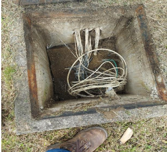
Figura A. 33: Pozo de revisión entre el Bloque los A2 (laboratorios) y A6 (Cuarto de máquinas). Fuente: Compilada por el autor
