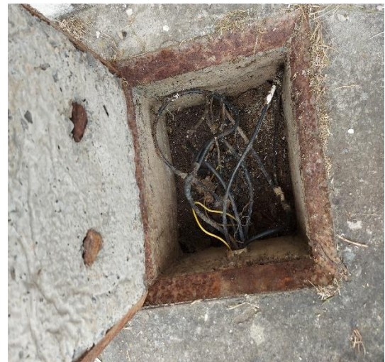
Figura A. 22: Puesta a tierra identificada en el pozo de revisión detrás bloque A10.
