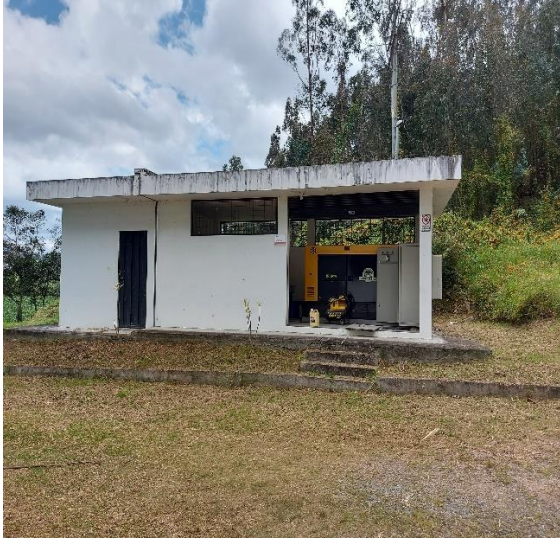
Figura A. 15: Cuarto de máquinas (Bloque A6) que provee las conexiones eléctricas al Bloque A2. Fuente: Compilada por el autor
