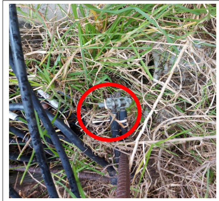
Figura 34. Empalme eléctrico identificado detrás del bloque A7, sin aislamiento eléctrico.
