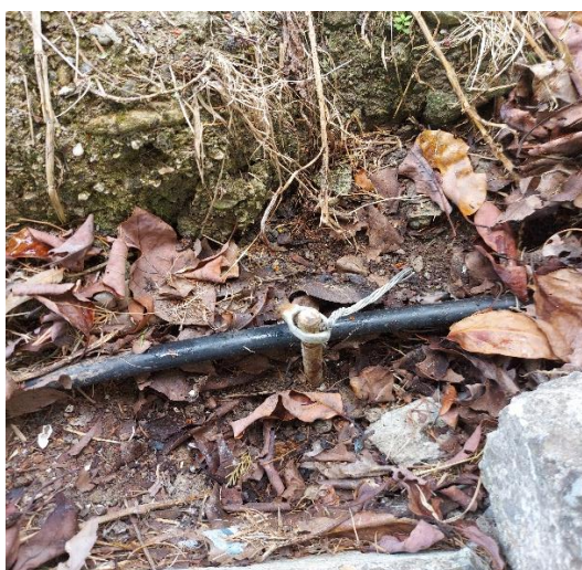
Figura A. 23: Puesta a tierra identificada detrás bloque A13, INACTIVA.
