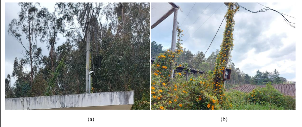
Figura 31. Acometidas de distribución eléctrica. (a) Poste 069124 que sirve de bajante e ingreso de las líneas de distribución hacia el bloque A6. (b) Poste 140840 que soporta el medidor de distribución eléctrica y sirve de distribución hacia los bloques A24 y A25.
