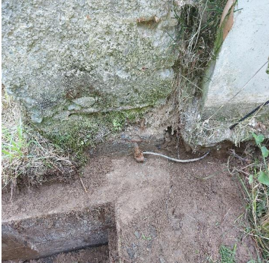
Figura A. 19: Puesta a tierra identificada detrás del bloque A3.
