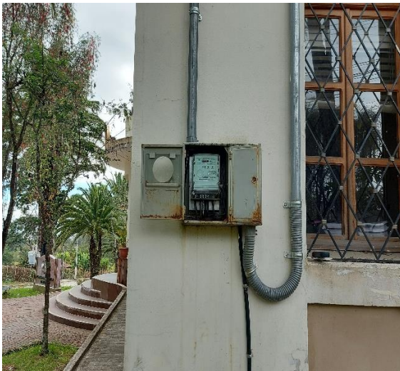
Figura A. 5: Medidor de distribución eléctrica 225180. Ubicado en el Edificio de Modalidad de Estudio a Distancia (MED). Fuente: Compilada por el autor.
