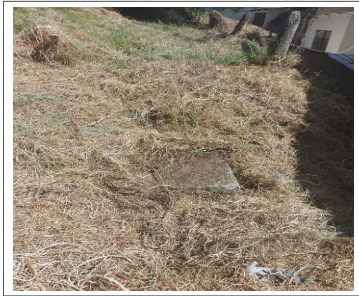
Figura 46. Pozo de revisión del sistema eléctrico identificado en la parte posterior del Bloque 8.
