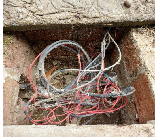
Figura A. 38: Pozo de revisión ubicado fuera del bloque A13 (Decanato). Fuente: Compilada por el autor
