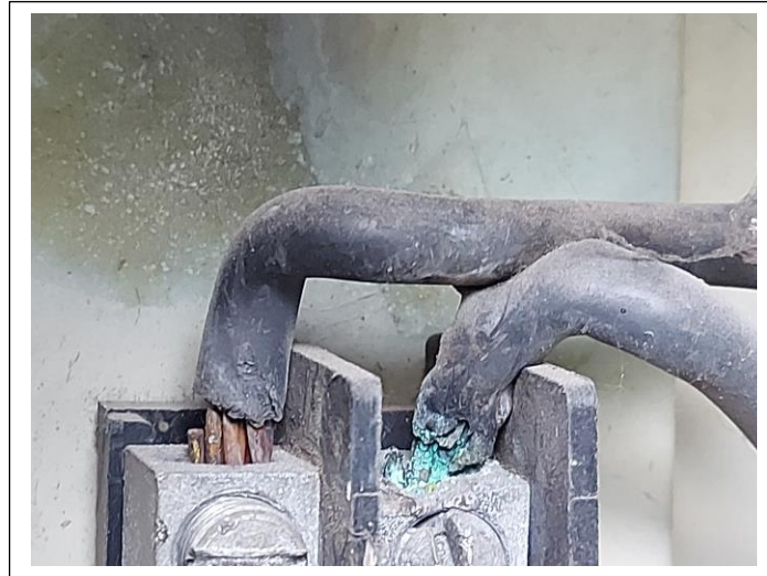
Figura 35. Cableado del medidor de distribución ubicado en los exteriores de bloque A13 (Decanato).
