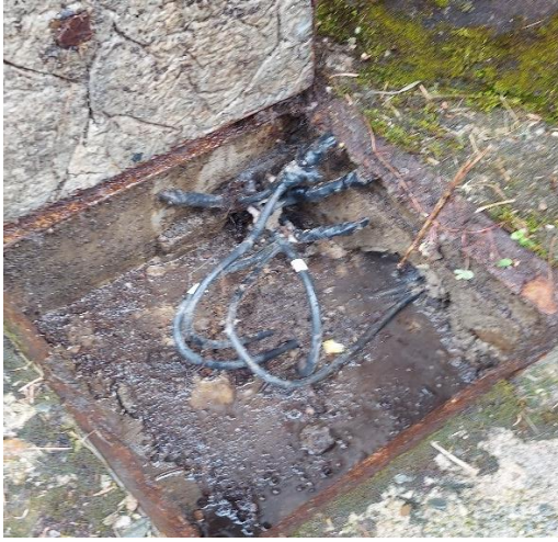
Figura A. 37: Pozo de revisión ubicado detrás del bloque A10. Fuente: Compilada por el autor
