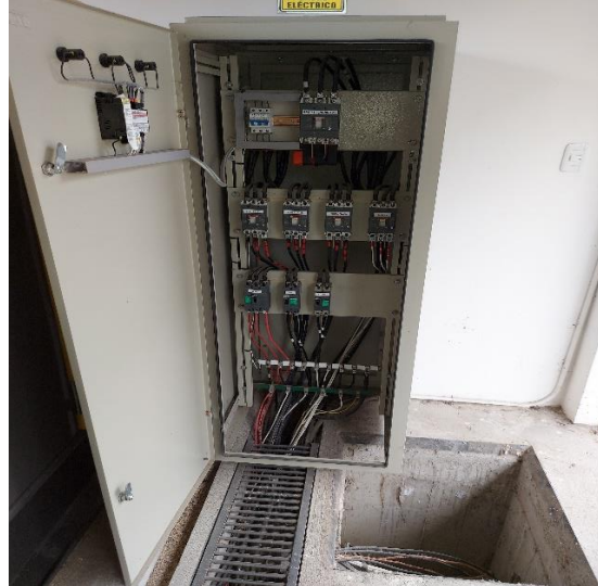
Figura A. 16: Gabinete de distribución eléctrica del Bloque A2. Fuente: Compilada por el autor
