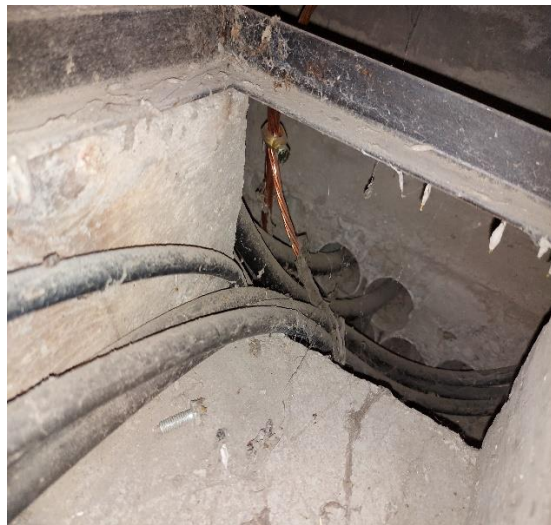
Figura A. 18: Puesta a tierra del sistema eléctrico del bloque A2. Fuente: Compilada por el autor
