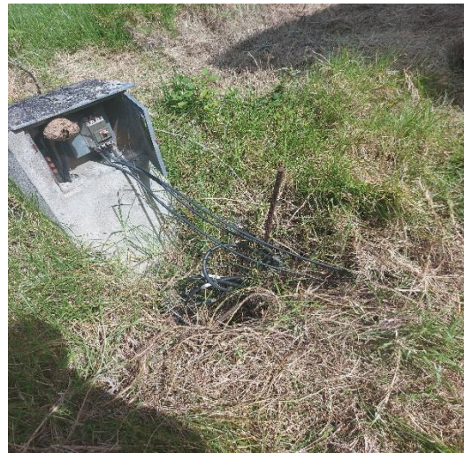
Figura A. 36: Pozo de revisión ubicado detrás del bloque A7. Ingreso de la red de media tensión a la facultad. Fuente: Compilada por el autor
