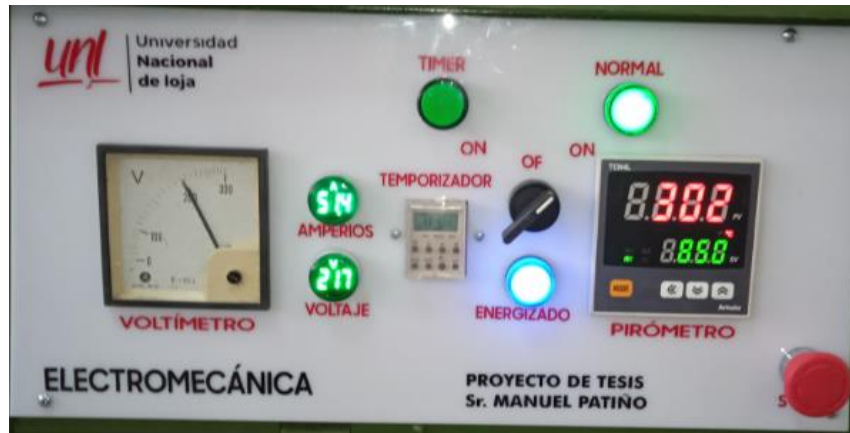
Figura 30. Tablero de control. Fuente: Propia
