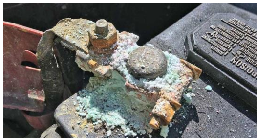
Figura 51: Sulfatación en batería de Plomo-ácido. Fuente: www.intarcesoft.com.ve
