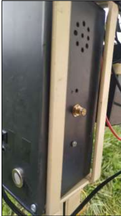
Ilustración 26. Punto de colocación de la antena transmisora.
