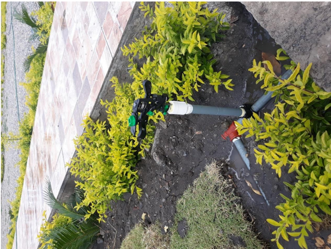
Figura 68 vista de aspersor calibrado y listo para su funcionamiento
