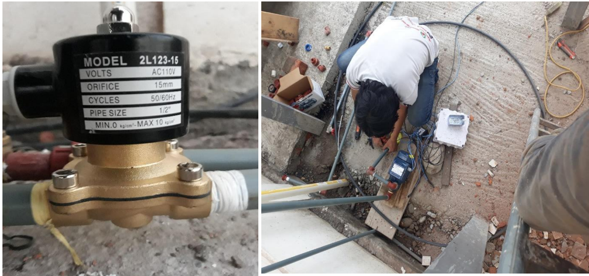
Figura 38 Instalación de bomba y electroválvula
