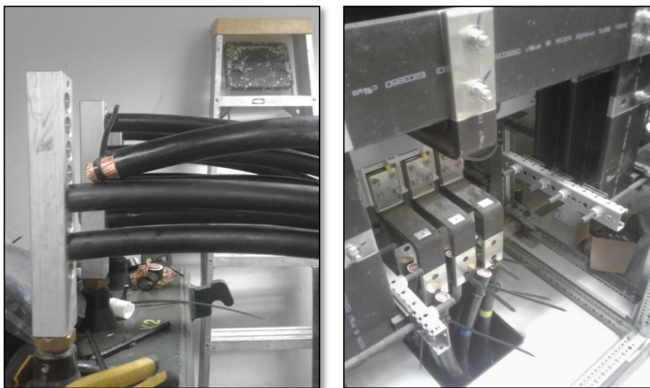
Figura 95. Cable de Cu previo a la conexión entre el transformador (500kVA) y el cuadro de distribución.
