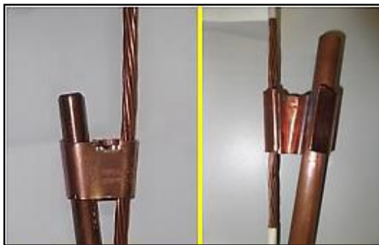
Figura 112. Conexión del cable Cu Nro. 2 WGA con conector H a la varilla Copperweld.
