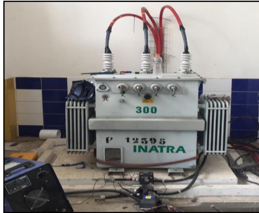
Figura 91. Conexión de transformador particular (Estadio “Reina del Cisne”) a la red de media tensión.
