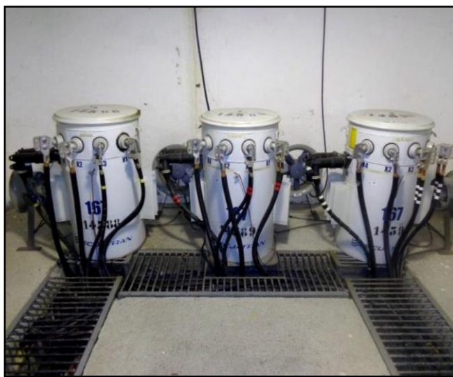
Figura 88. Transformadores monofásicos instalados en cámara de transformación.
