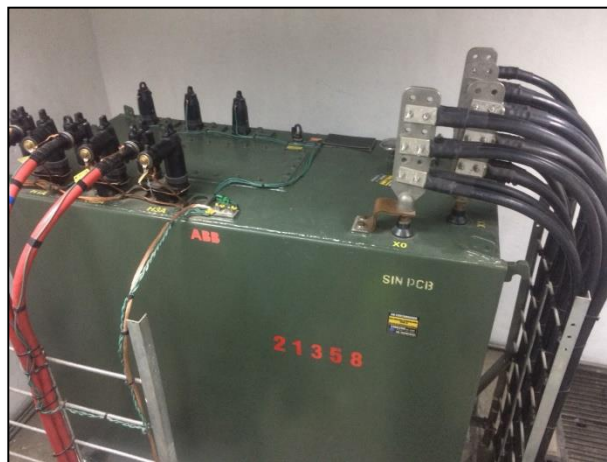
Figura 90. Transformador trifásico de 750 kVA instalado en cámara de transformación.
