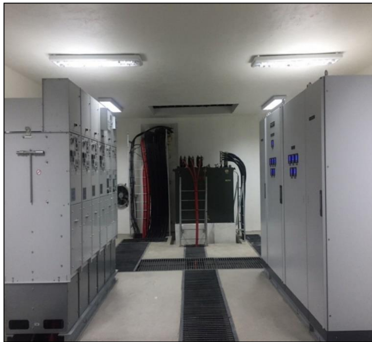
Figura 79. Componentes principales instalados en el interior de las cámaras de transformación.
