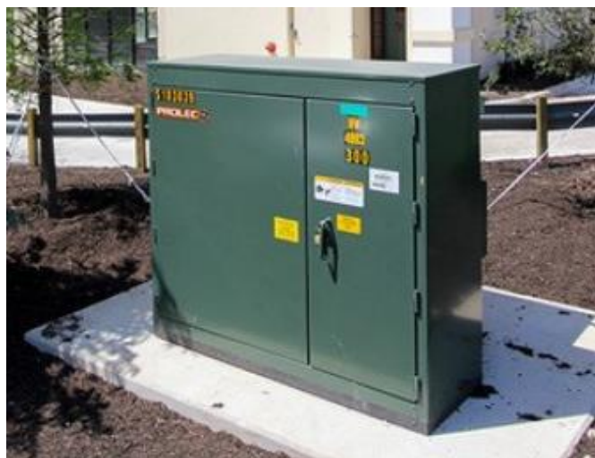
Figura 36. Transformador tipo pedestal.
