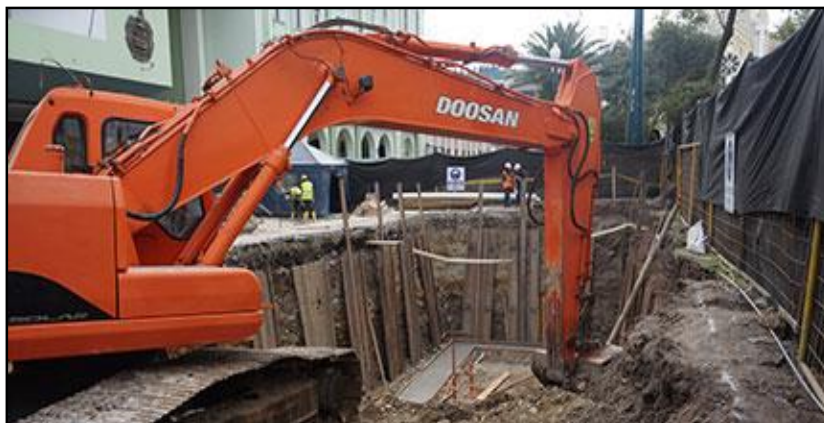
Figura 45. Movimiento de tierra para construcción de cámaras eléctricas en el parque central.
