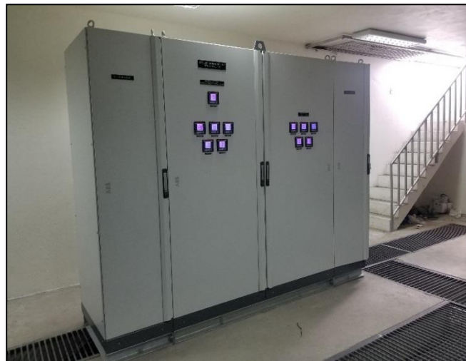
Figura 92. Tablero de distribución de baja tensión.
