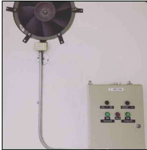
Figura 98. Sistema de ventilación en la C.T. 08.
