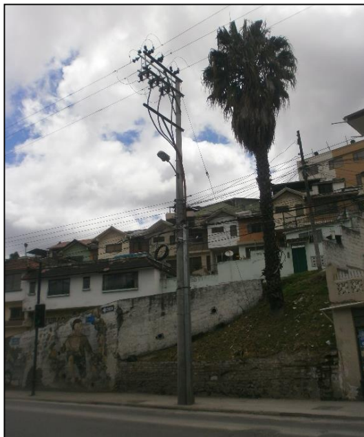
Figura 66. Transición aérea – subterránea.
