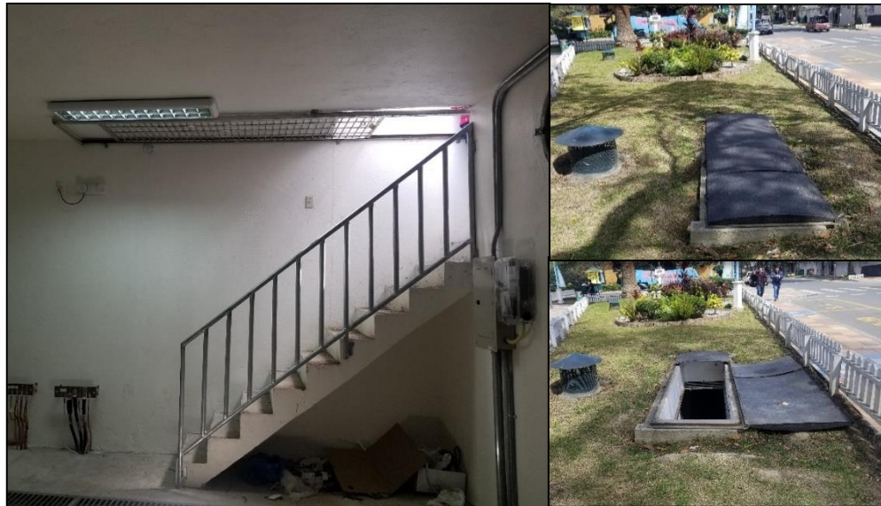
Figura 60. Acceso a cámaras de transformación mediante gradas.
