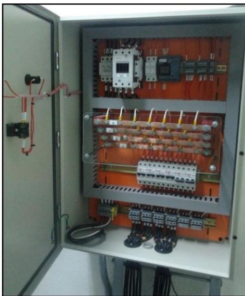
Figura 126. Cuadro de mando y control de los circuitos del alumbrado público.
