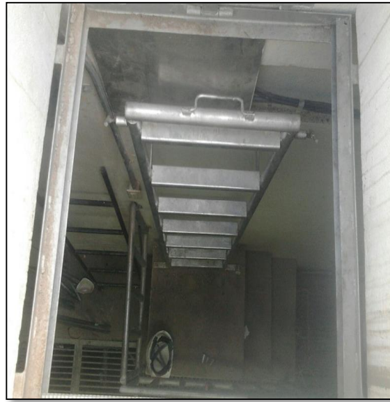
Figura 61. Acceso a cámaras de transformación con escalera telescópica.
