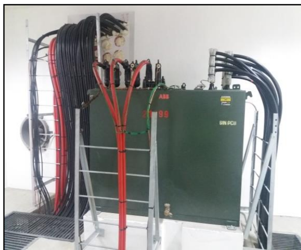
Figura 89. Transformador trifásico de 500 kVA instalado en cámara de transformación.
