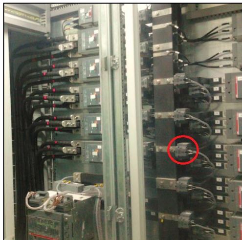
Figura 107. Fusibles tipo cuchilla dispuestas en el cuadro de distribución.
