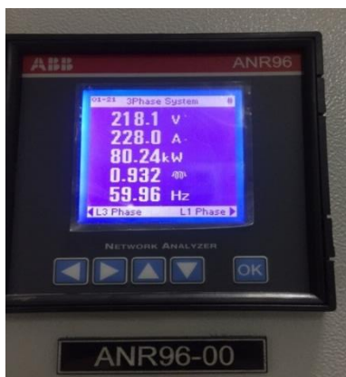
Figura 94. Pantalla digital indicador de parámetros y magnitudes eléctricas.
