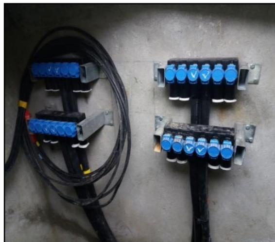
Figura 108. Barrajes de baja tensión en pozos eléctricos.
