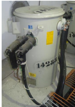
Figura 34. Transformador convencional con frente muerto.
