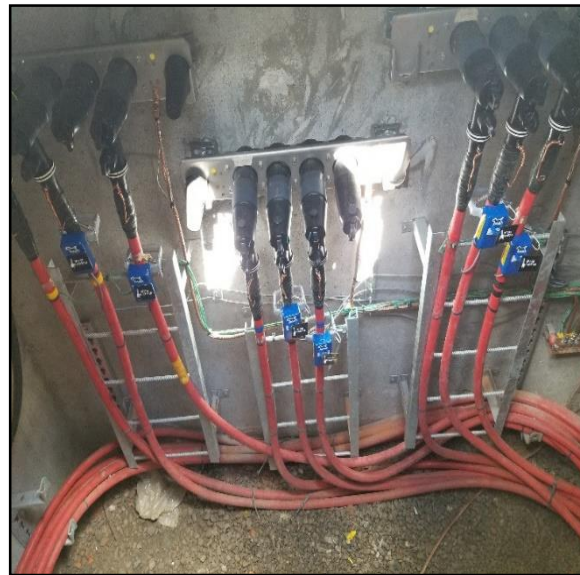
Figura 77. Barrajes de Media Tensión con indicadores de falla en pozos eléctricos tipo E.
