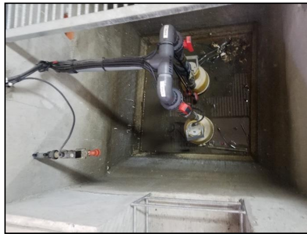
Figura 99. Bombas sumergibles utilizadas para el sistema de drenaje.
