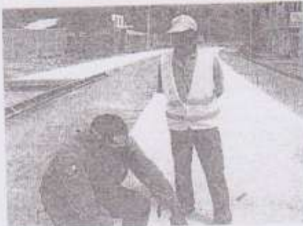
Alcantarillado en malas condiciones paraliza trabajos.
