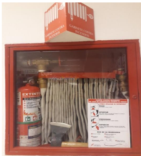
Figura 43. Gabinete contra incendios Fuente: Elaboración propia
