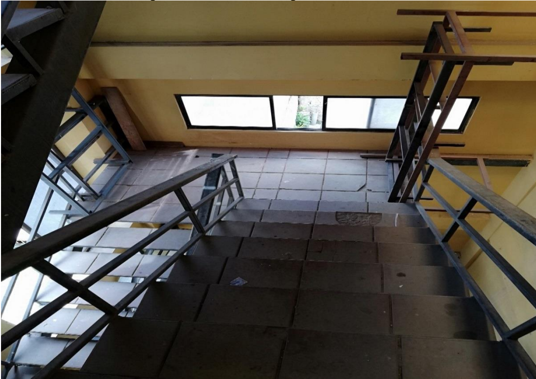
Figura 49 Gradas de Emergencia Hotel Bombuscaro
