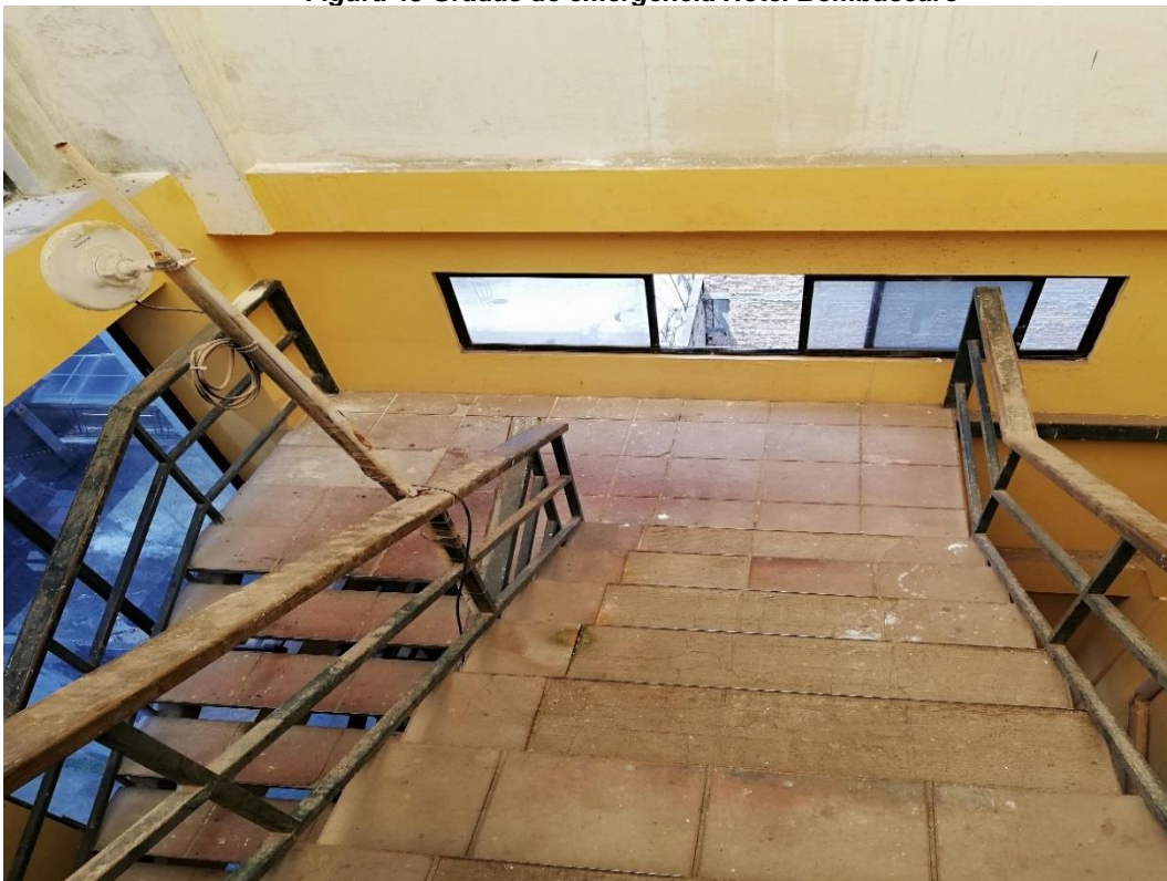
Figura 48 Gradas de emergencia Hotel Bombuscaro
