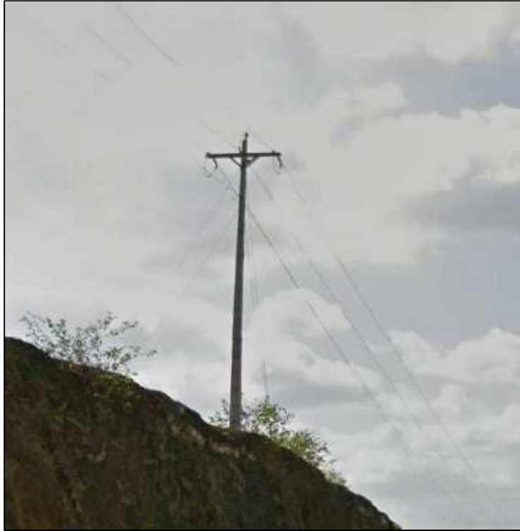
Figura 61. Punto de conexión. Fuente: Propia del autor.
