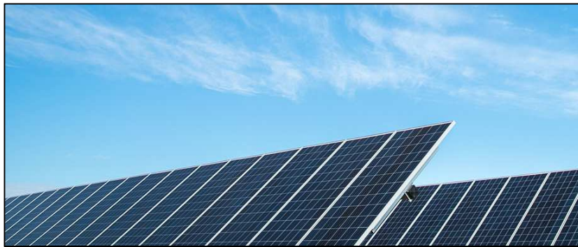
Figura 13. Disposición de paneles solares. Fuente: (AUTOSOLAR, 2018).
