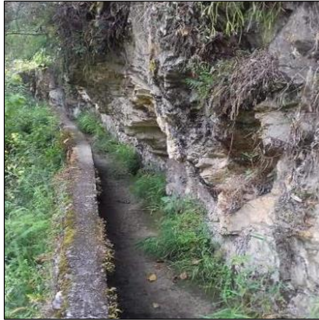
Fotografía 69. Canal con la pared de roca en la sección N° 12. Fuente. La Autora, 2019.
