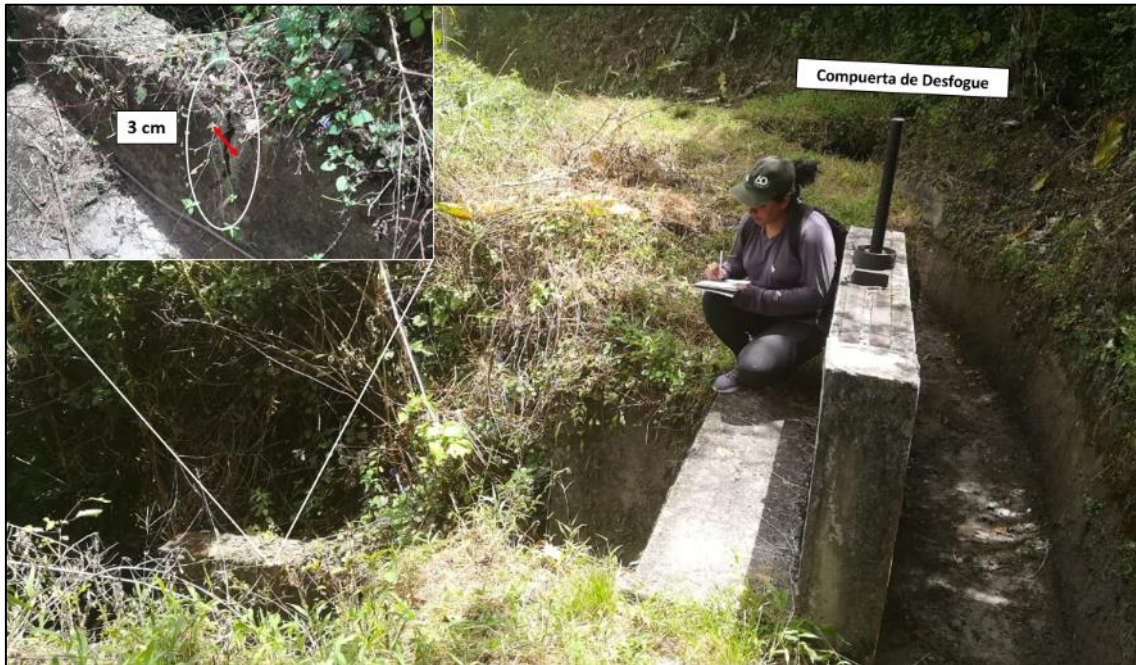
Fotografía 57. Compuerta de desfogue, en el tramo II. Fuente. La Autora, 2019.
