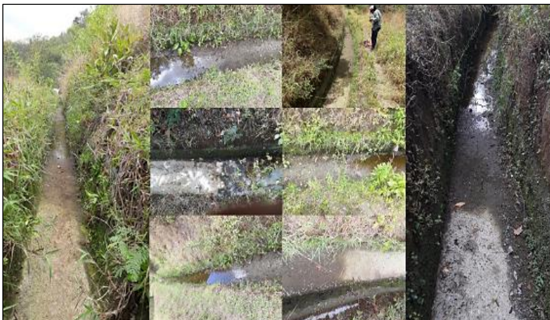
Fotografía 51. Asentamientos en la infraestructura del tramo II. Fuente. La Autora, 2019.
