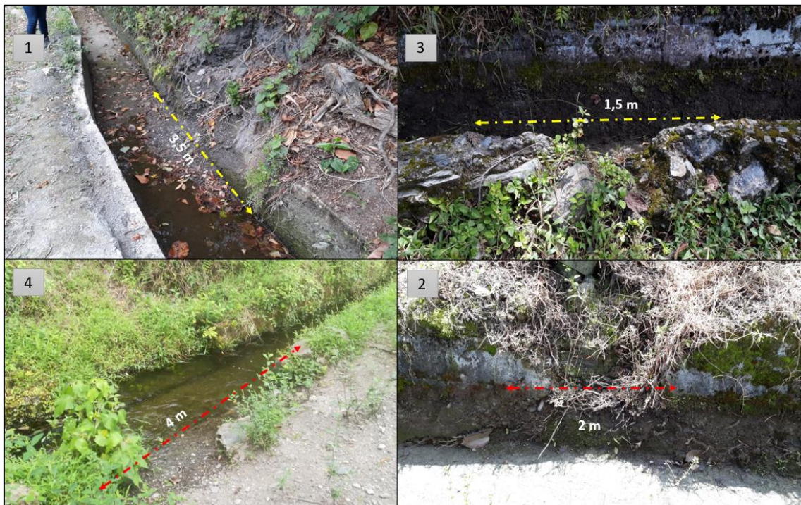
Fotografía 50. Desprendimientos a lo largo del tramo II. Fuente. La Autora, 2019.
