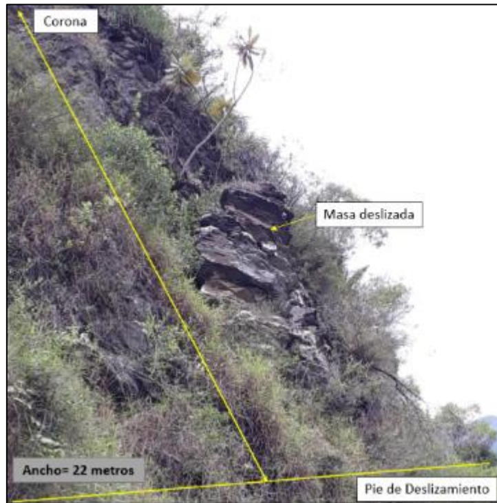
Fotografía 44. Deslizamiento N° 3 perteneciente al tramo II. Fuente. La Autora, 2019.
