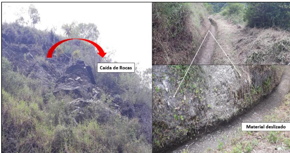
Fotografía 47. Segunda zona inestable del tramo II. Fuente. La Autora, 2019.
