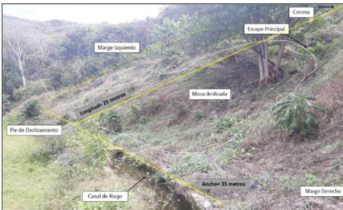
Fotografía 42. Deslizamiento N° 1 perteneciente al tramo II. Fuente. La Autora, 2019.
