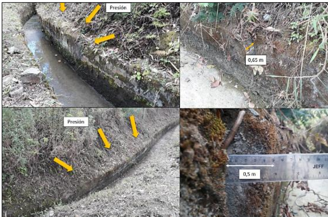
Fotografía 56. Volcamiento de los muros del canal. Fuente. La Autora, 2019.
