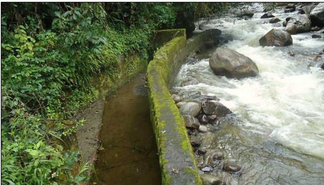
Fotografía 31. Boca toma del Canal Alto San Pedro de Vilcabamba. Fuente. La Autora, 2019.
