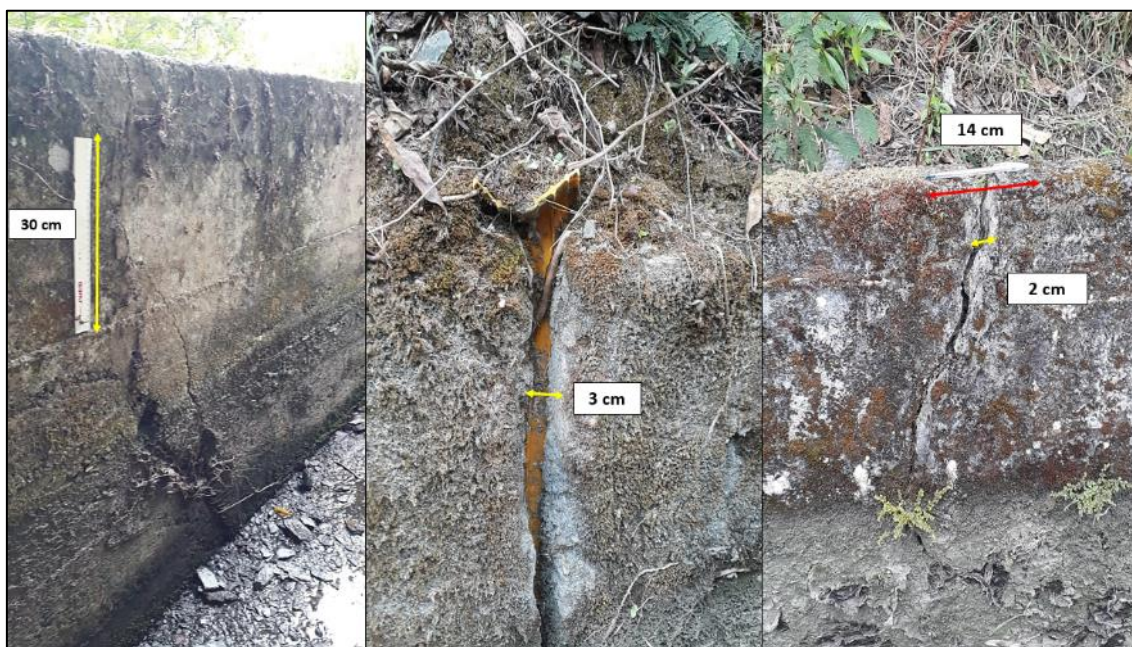
Fotografía 55. Grietas a lo largo del tramo II. Fuente. La Autora, 2019.
