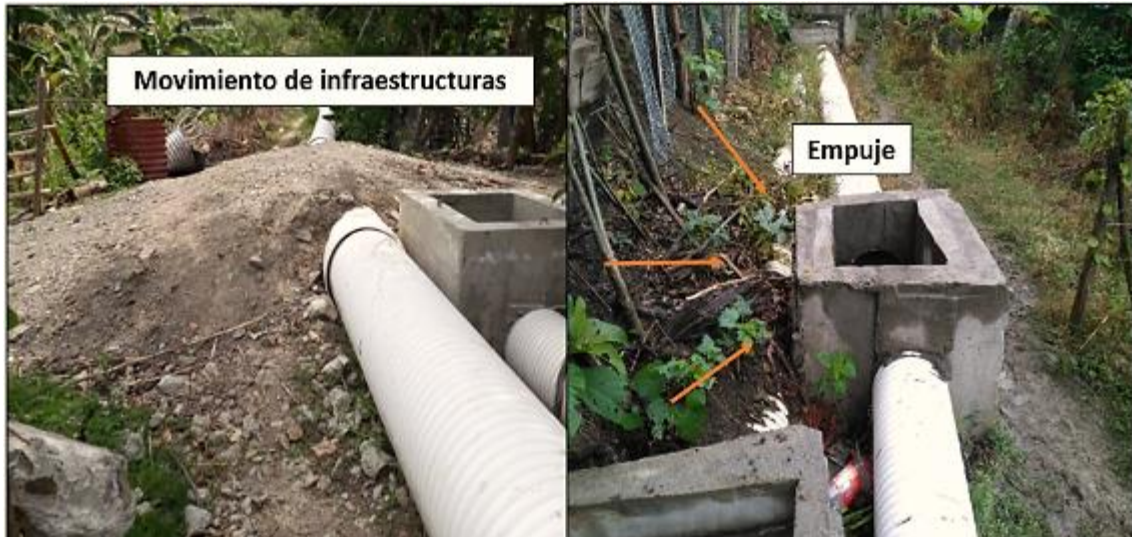
Fotografía 20. Infraestructura dañada por las arcillas expansivas. Fuente. La Autora, 2019.
