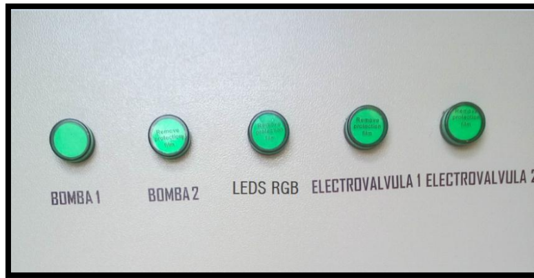
Figura 58: Luces de señalización del tablero de control
