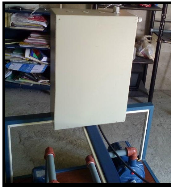
Figura 50: Montaje del tablero de control
