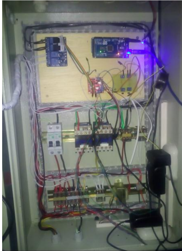
Figura 59: Montaje de los dispositivos electrónicos en el tablero
