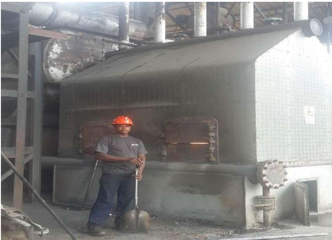
Generación de vapor en las calderas Fuente: Investigación Tomada por: Edgar Sarrias
