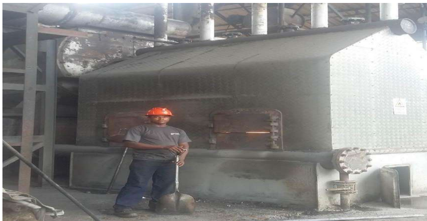
Figura 40. Generación de vapor mediante calderas. Fuente: Investigación propia (2016). Por: Edgar Sarrias.
