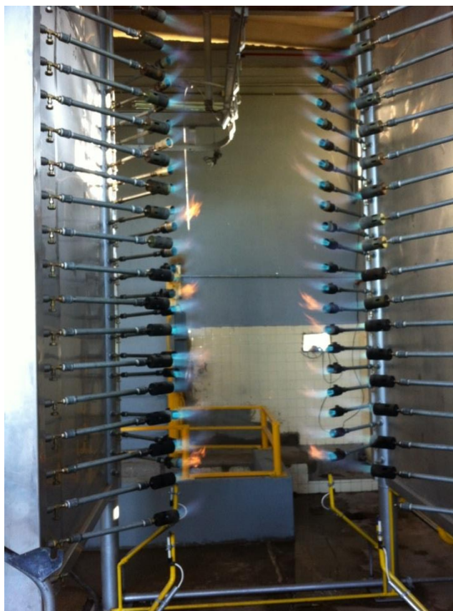
Figura I. Horno de rostizado existente
