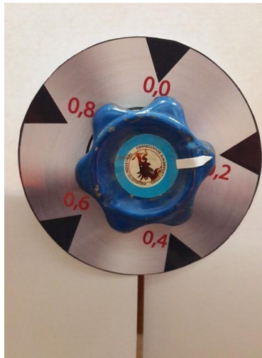
Figura XXXV. Vista válvula de control entrada a la boquilla.
