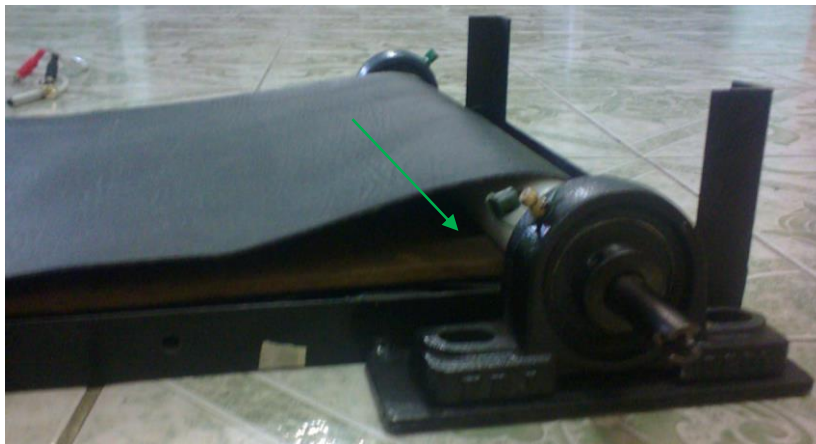
ANEXO Nro.-30 Parte lateral de la Banda Transportadora
