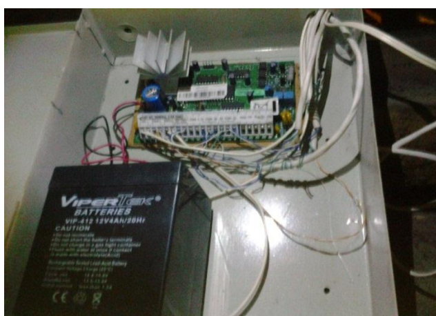
Fig. 11 Central de Alarma
