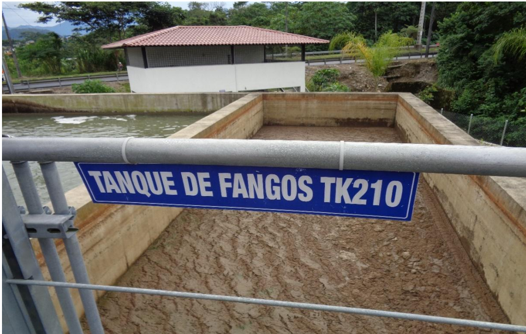
Tanque de fangos de la Planta de Tratamiento de Aguas Residuales de Palandacocha
