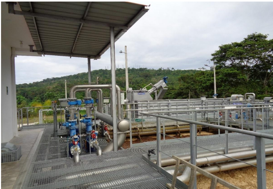
Maquinaria de la Planta de Tratamiento de Aguas Residuales -Palandacocha - Tena
