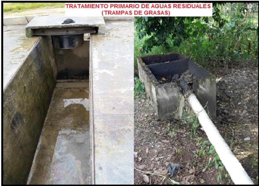
Fotografía 25.- Collage, tratamiento de aguas residuales.
