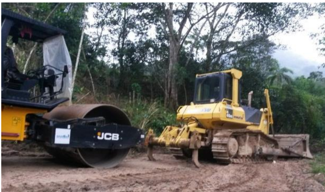
Fotografía 11. Maquinaria empleada en la compactación y cubrimiento de los residuos orgánicos e inorgánicos.
