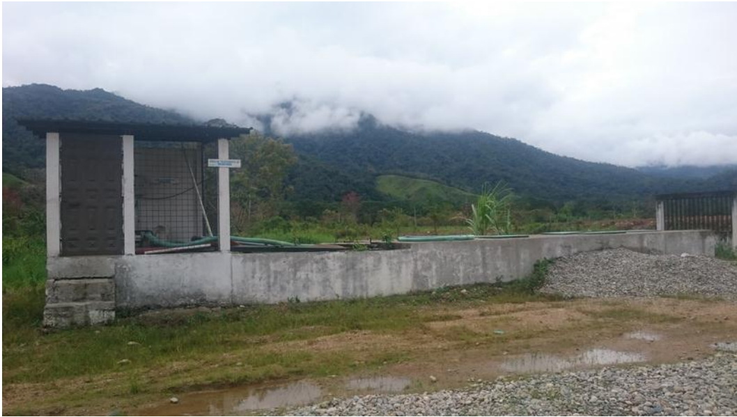
Fotografía 8. Área de tratamiento de aguas residuales
