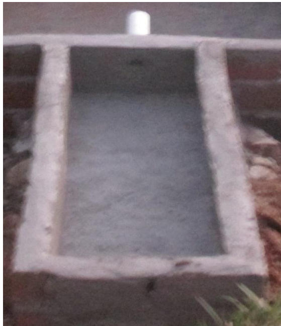
Fotografía 12. Caja de retención de sólidos gruesos
