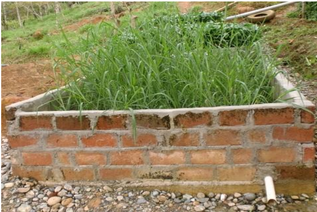
Fotografía 19. Puesta en marcha y funcionamiento del tratamiento físico biológico
