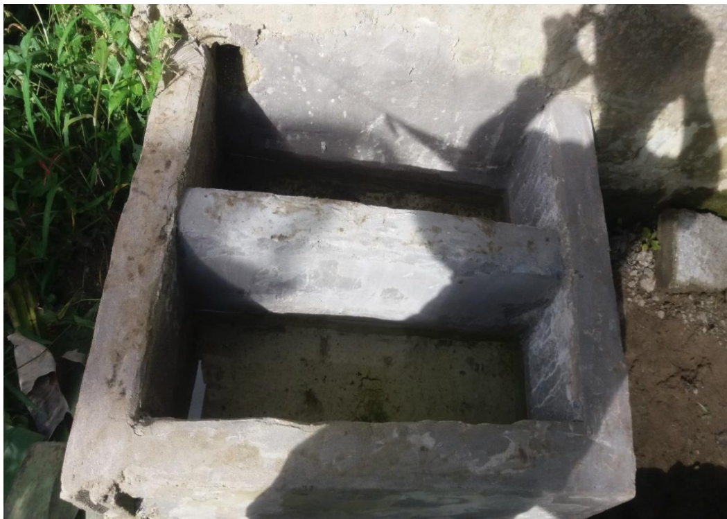
Fotografía 3. Sedimentador y trampa de grasas.
