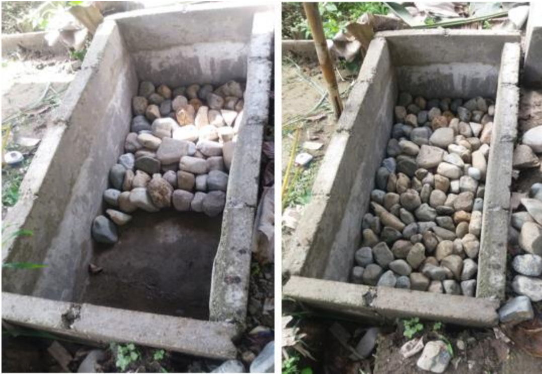
Fotografía 5. Colocación de una capa de piedra bola 100mm en el tanque de biofiltración.
