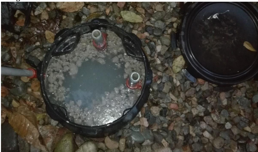
Tanque de tratamiento primario con residuos sólidos
