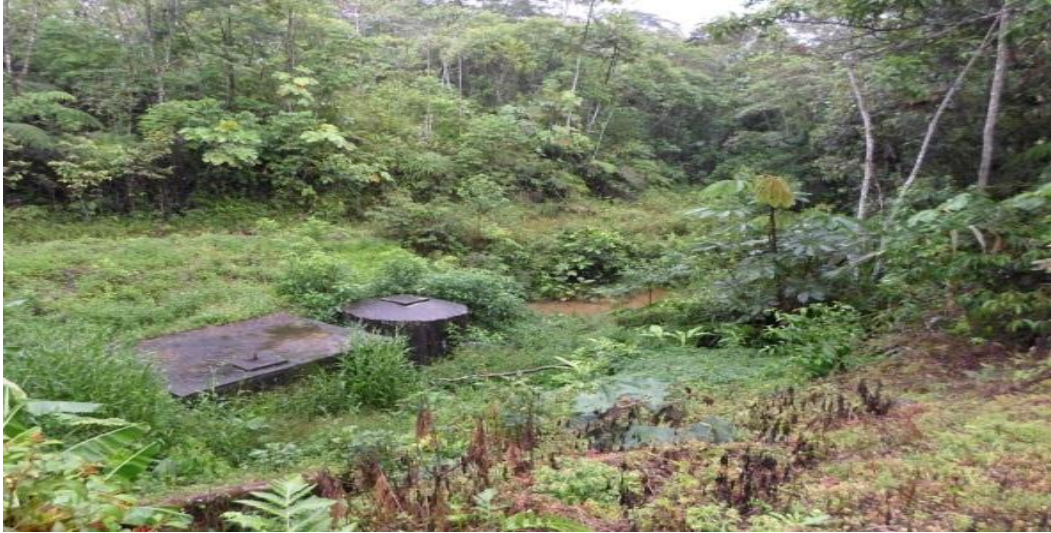
Planta de tratamiento para la celda cerrada
