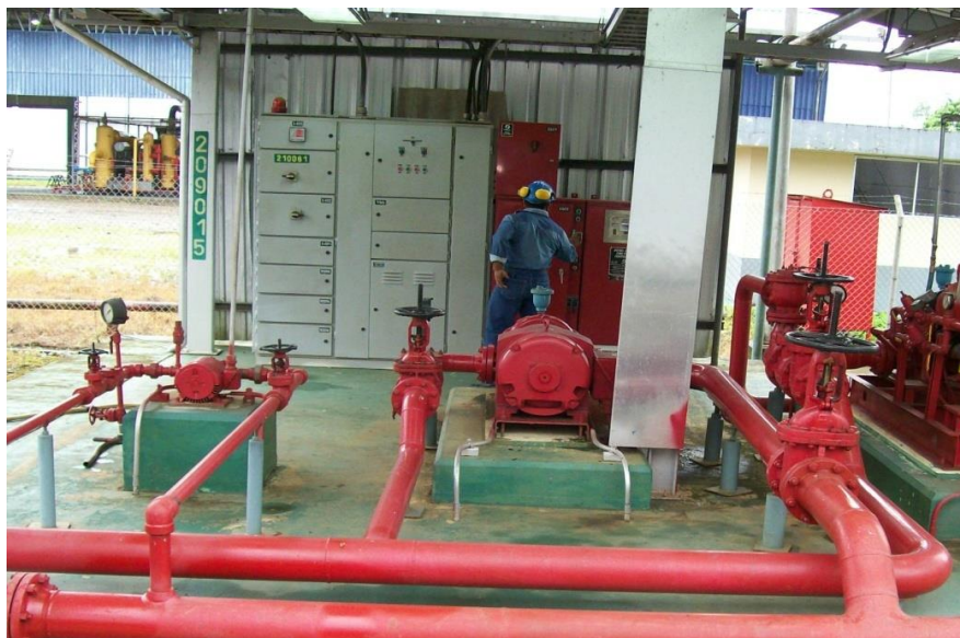
Figura. 2.42. Tablero de Distribución Principal y caseta de Bombas
