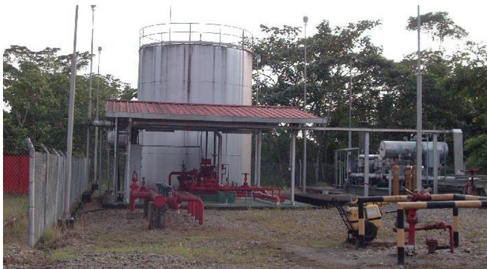
Figura. 2.40. Tanque de reserva de agua.
