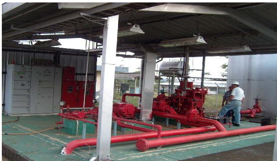
Figura. 2.41 Caseta de Bombas
