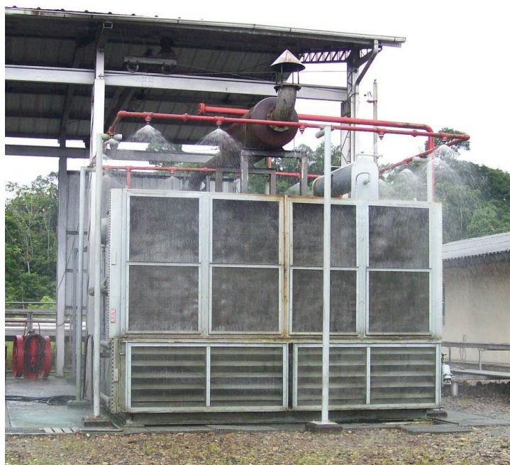
Figura 2.46. Funcionamiento de los Sprinklers para el enfriamiento de los tanques.
