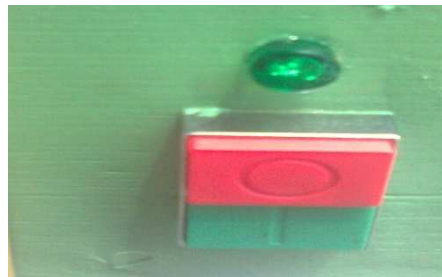
Figura 4.26: Pulsador de encendido y apagado
