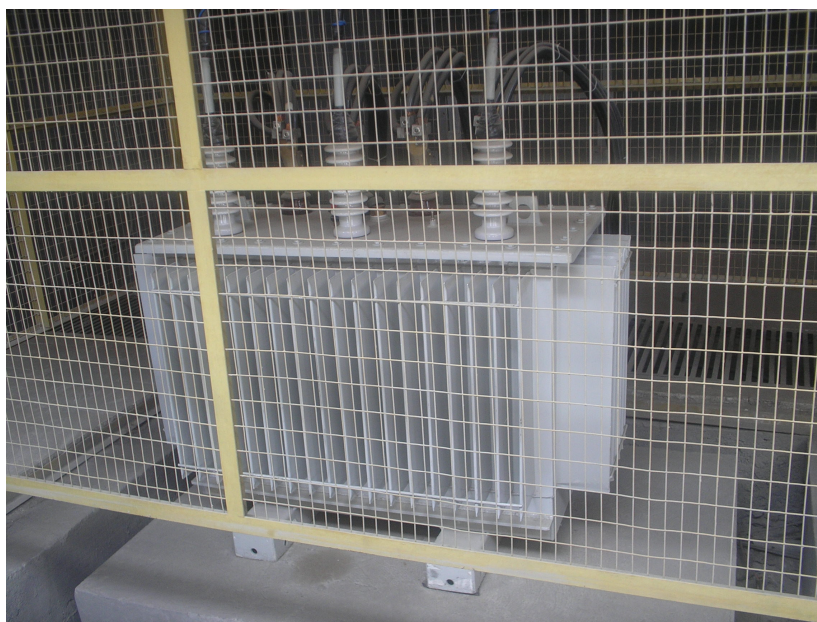
Figura 3. Transformador principal de alimentación (300 kVA)
