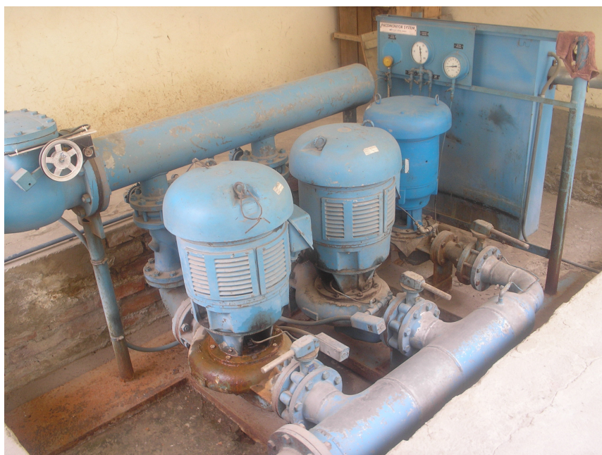
Figura 6. Sistema de bombeo
