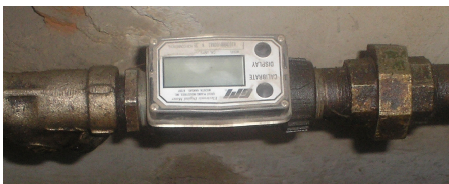
Figura 11. Caudalímetro en el sistema de diesel de la caldera
