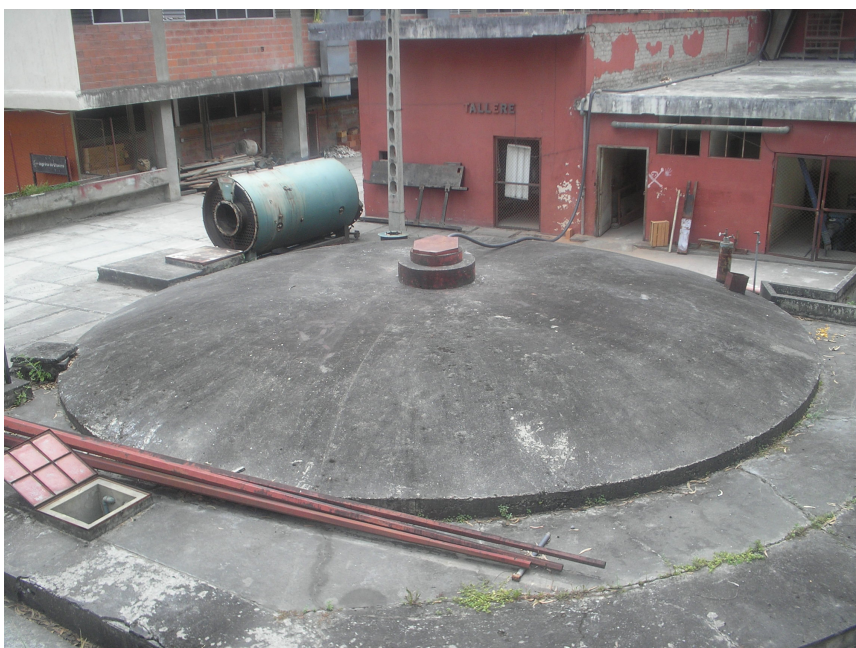
Figura 16. Cisterna de abasto de agua
