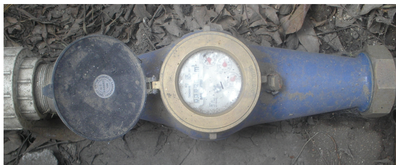
Figura 18. Medidor mecánico de volumen de agua
