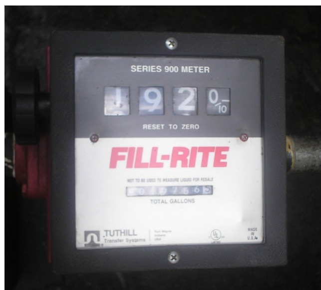
Figura 8. Contador de volumen mecánico de diesel
