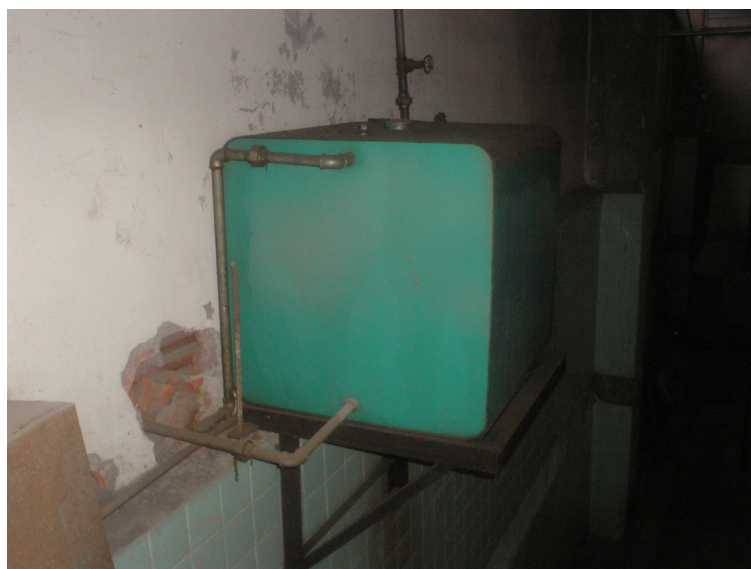
Figura 15. Tanque de alimentación del generador
