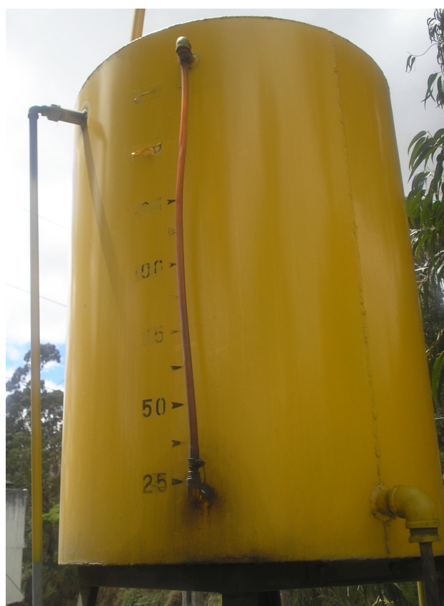
Figura 13. Tanque de alimentación del incinerador
