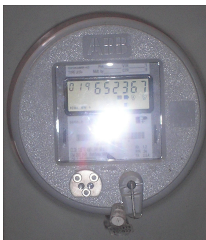
Figura 5. Medidor digital de energía
