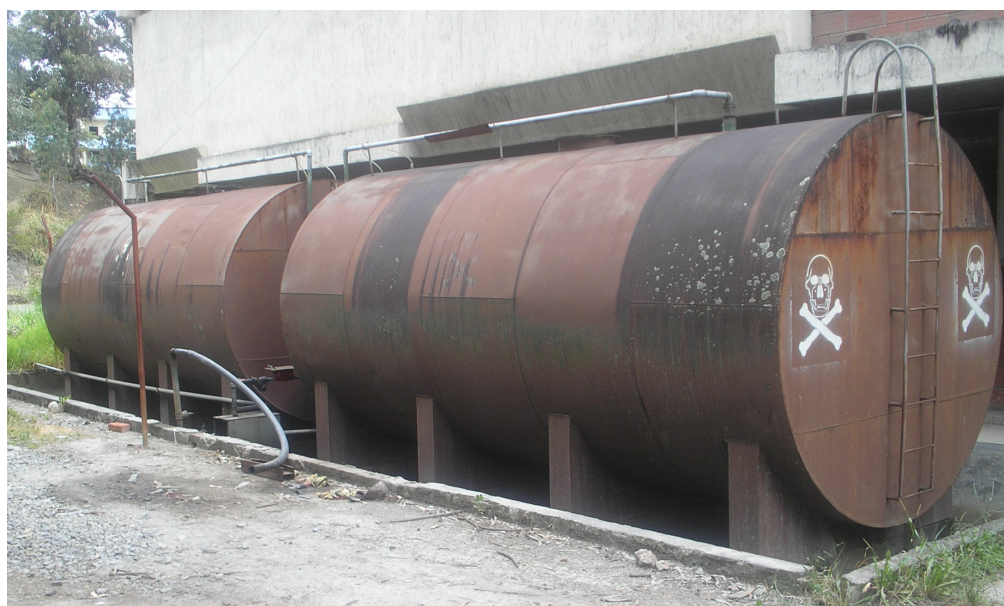
Figura 7. Tanques de alimentación principal de diesel
