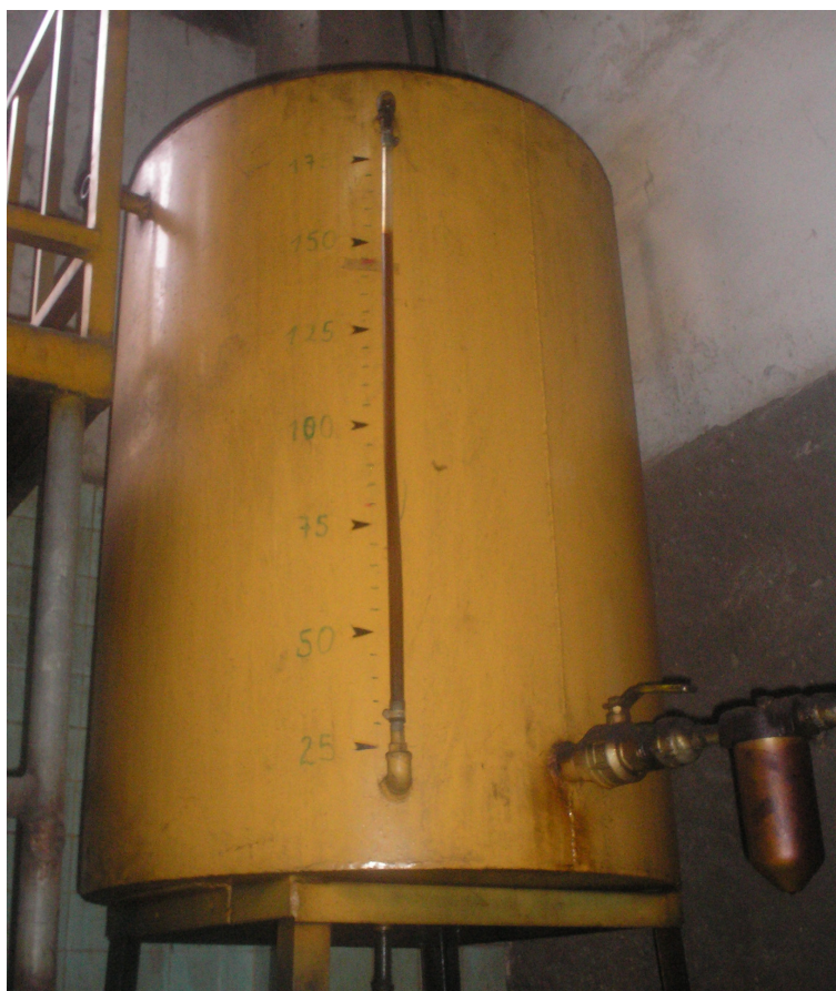
Figura 10. Medición en el tanque de alimentación de la caldera
