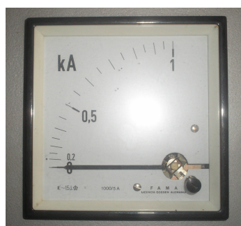
Figura 4. Instrumento de medición de corriente instalado en el tablero general
