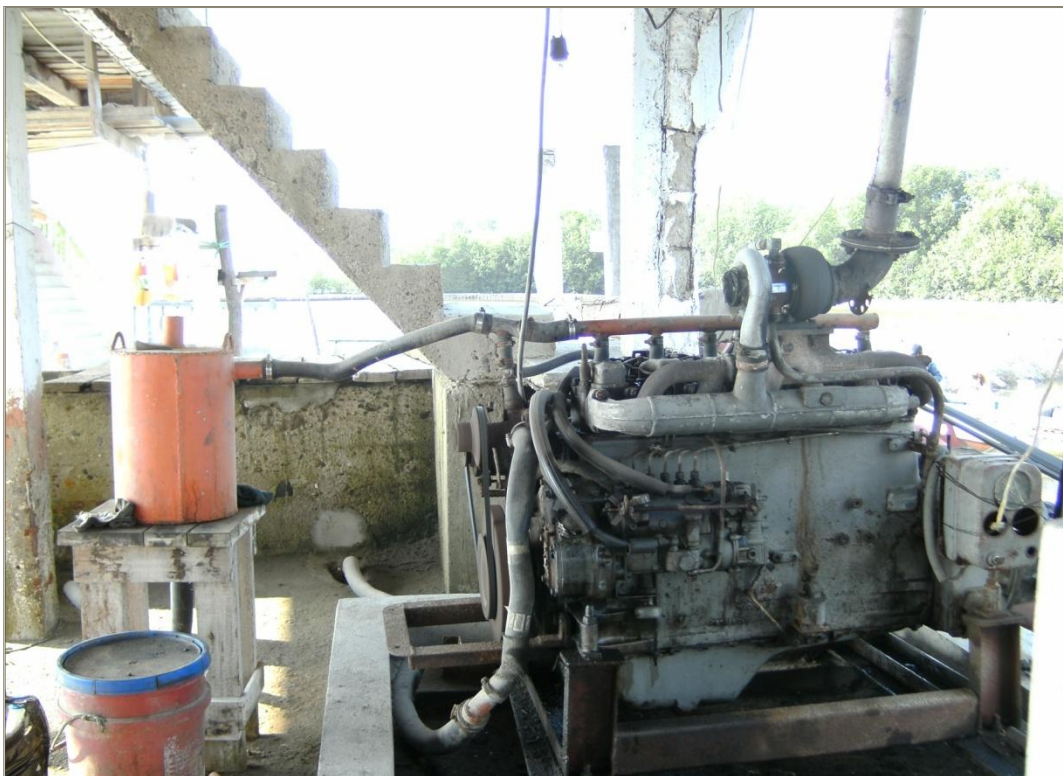
MOTOR (Para bombear agua a la piscina)
