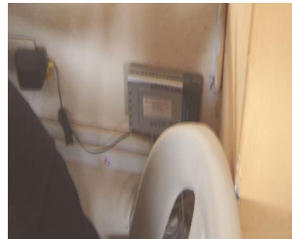
IMAGEN 1.10 Switch de 12 puertos Biblioteca
