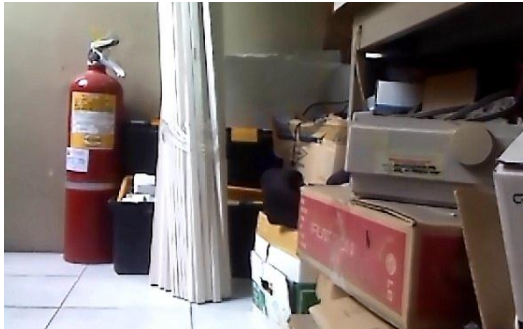
Ilustración 142. Extintor de incendios
