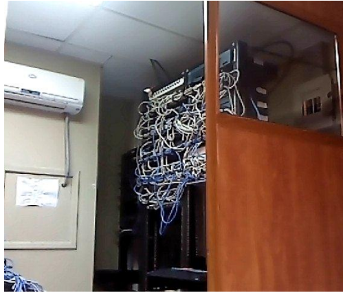
Ilustración 140. Cuarto de telecomunicaciones
