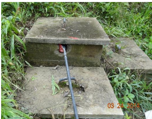
Fotografía 5. Instalación para llevar el lixiviado hacia las piscinas.
