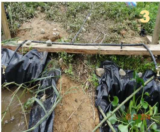
Instalación para el ingreso del lixiviado a las piscinas
