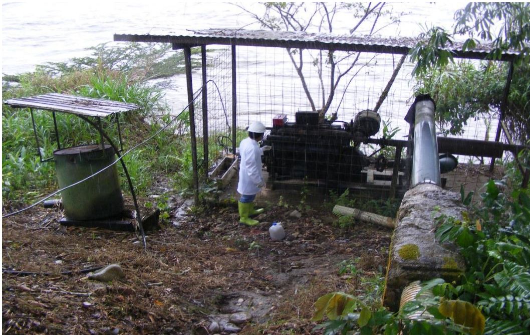
Foto. 5. Casa de máquinas
