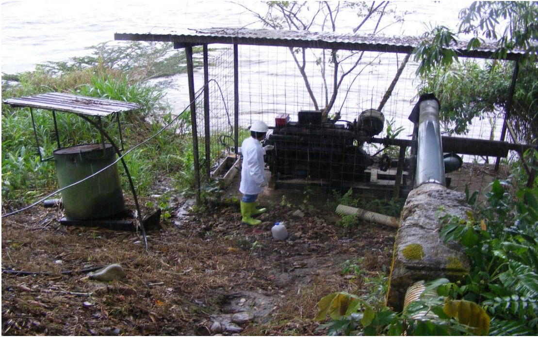
Foto. 9. Análisis del generador de energía eléctrica
