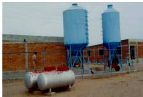
GRÁFICO 3. Contenedores de alimentos y abastecimiento de gas.
