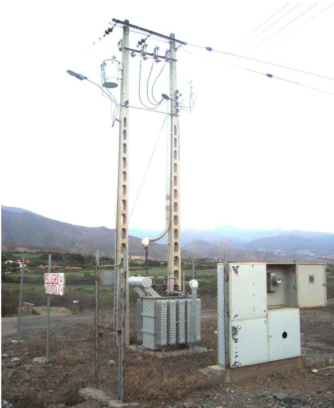
Anexo 1. Subestación del Campamento Dr. Pedro Aguirre
