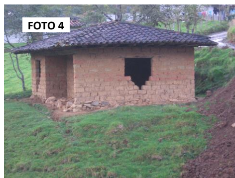
Foto 4: Vivienda sin terminar, deteriorada.
