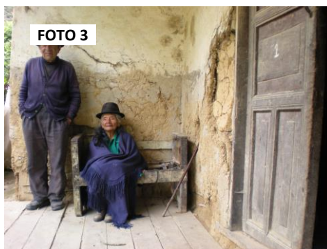
Foto 3: Vivienda con deterioro evidente.
