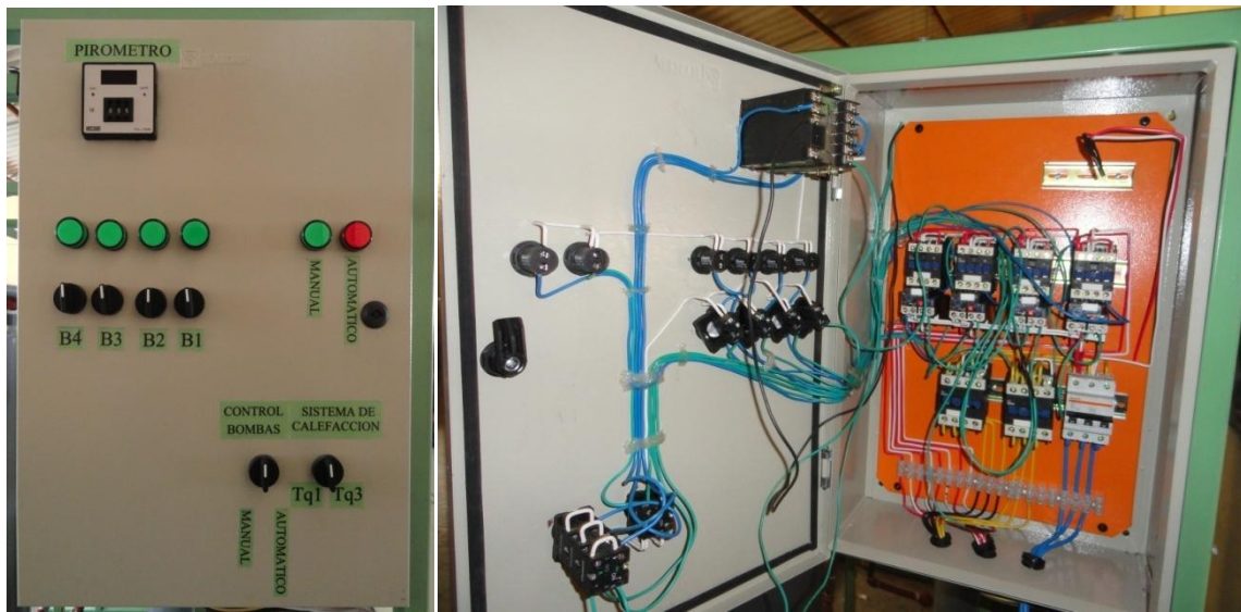
Fotografía 7. Tablero de control.
