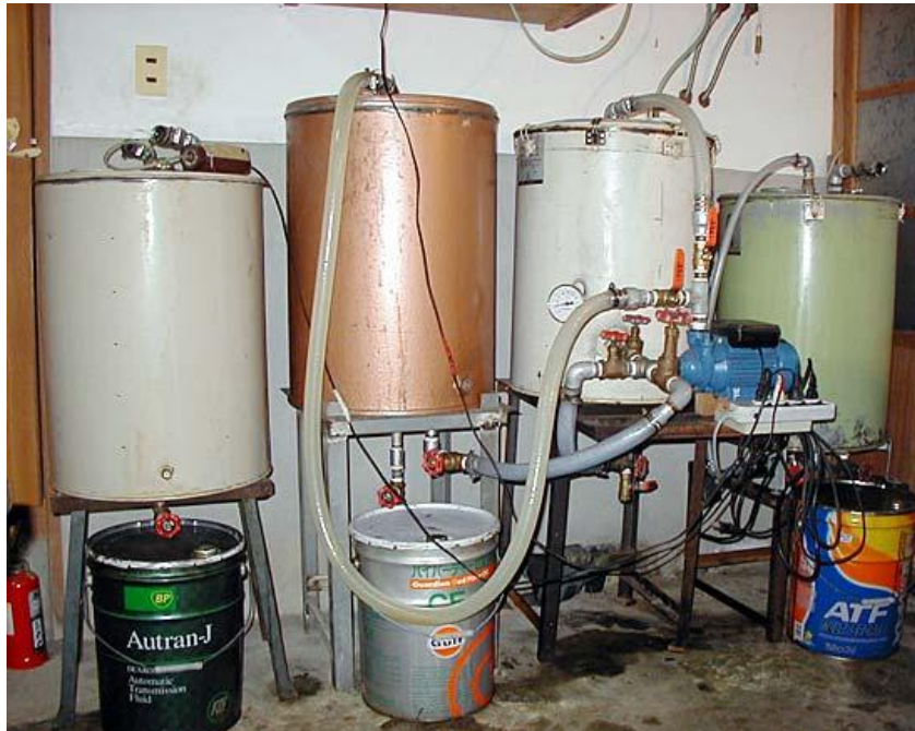
GRÁFICA 8. Reactor artesanal construido con material reciclado.
