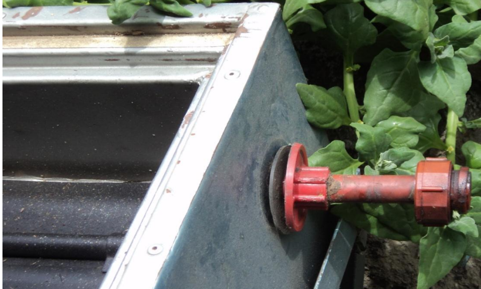
Figura 45: Contaminación en los accesorios del colector debido al aceite quemado.
