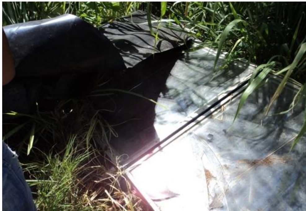
Deterioro de los colectores solares de la secadora solar de arroz.
