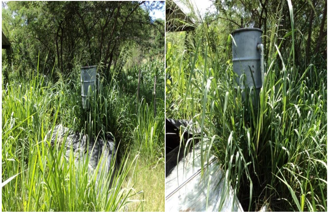
Figura 5: Situación actual de la secadora solar de arroz en el Centro Binacional de formación técnica de Zapotepamba.
