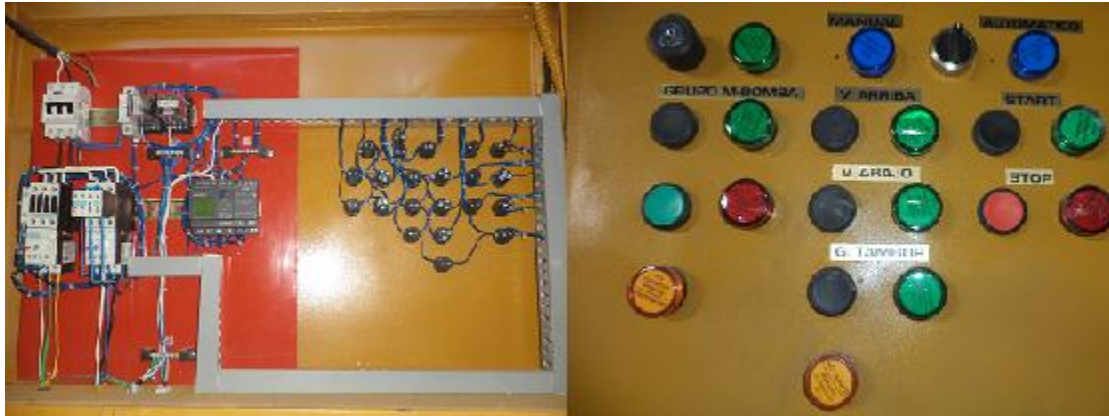
Foto 18: Sistema de control y mando
